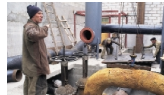
Reoveringen af fjernvarmeværket i Pärnu har reduceret CO 2 -udledningen med 10 procent.
