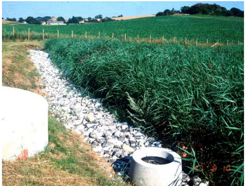
Figur 4.3 Beplantet filteranlæg ved Bjødstrup-Landborup, til løbsfaskine. Til venstre ses bundfældningstank (Foto: H. Brix)
