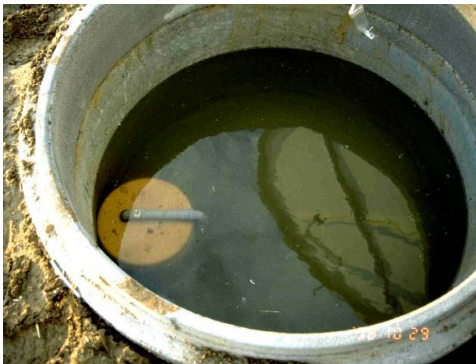
Figur 4-4 Brønd med selvstartende sifonanordning ved Bjødstrup-Landborup anlægget (Foto: H. Brix)
