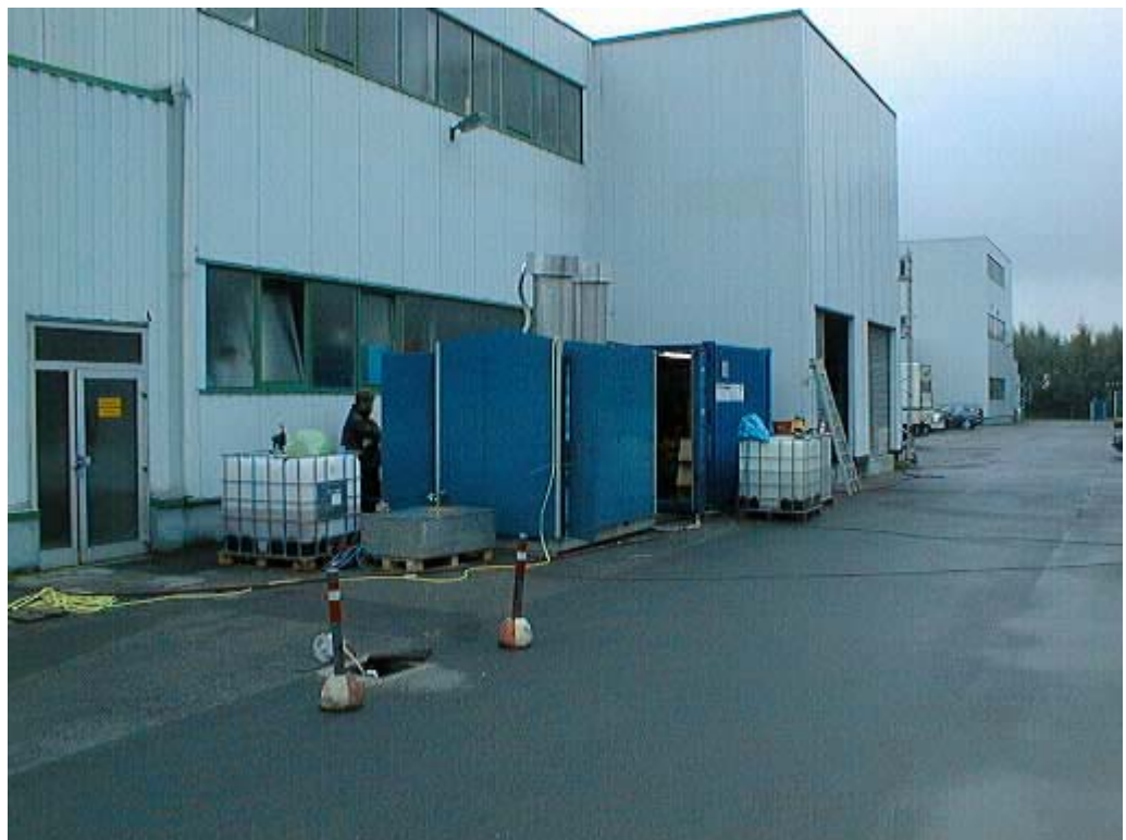
Figur 4.4 MPPE-anlæg på forurenede renserigrund, Dortmund. Injektionsboring ses i forgrund. Pumpeboringen ses ved gul elkabel. Den hvide beholder indeholder tensid-blanding. Den forreste blå container indeholder MPPE-behandlingsanlægget med to kolonner. Den anden blå container indeholder værksted, generator og materialelager.
