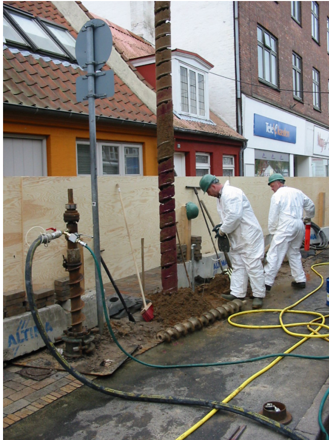
Injektion med hul snegl . Blev opgivet pga. ringe ydelse og optrængning af væske til terræn
