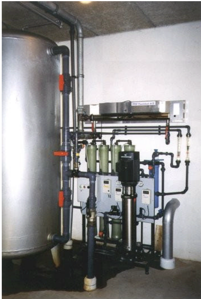
Figur 3.1 Membrananlæg på Enø Strands Vandværk (foto DVS Vandteknik)
