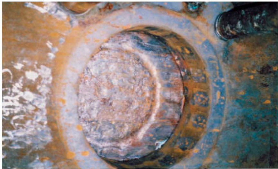
Billede 3: Ringformet erosion på ventilfladens inderside (ind mod kammeret). Billedet er taget fra kammersiden da kammer 3 blev nedtaget og lige inden kammer 4 blev sat op.
