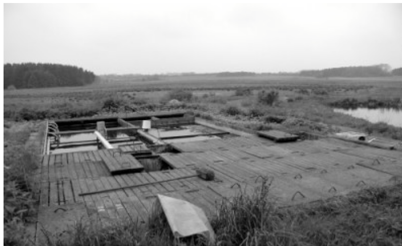
Figur 1.4 Overblik over renseanlægget på Svanholm Gods. Aktiv slamtankene findes under overdækningen foran i billedet og sedimentationstanken bagved. Plastfilteret ses til højre herfor
