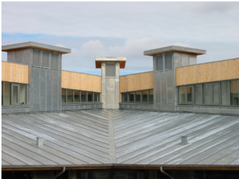
Figur 5. Hvert lokale sin skorsten. Den brugte luft trækker ud gennem skorstenene.
