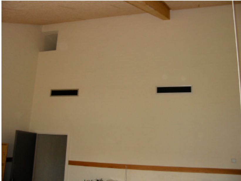
Figur 4. Luften ledes fra kældergangene ind i de enkelte lokaler gennem åbninger i væggen. Den brugte luft trækker ud gennem huller ved loftet.
