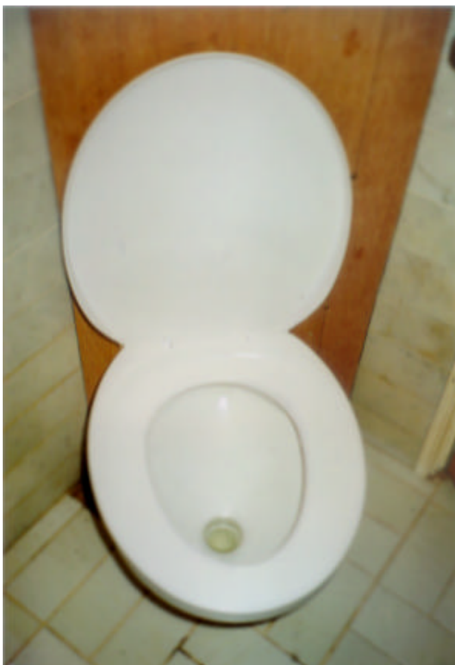
Figur 7.3 Afløbet i det kildesamlende vakuumtoilet.
