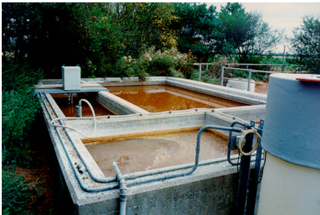
Figur 8.2 Slamtank på Kramnitze renseanlæg. Foto: Storstrøms Amt.
