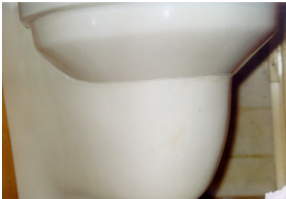
Figur 7.2 Vakuumtoilet nr. 2 i Strandby (bemærk samlingen sammenlignet med figur 7.1).
