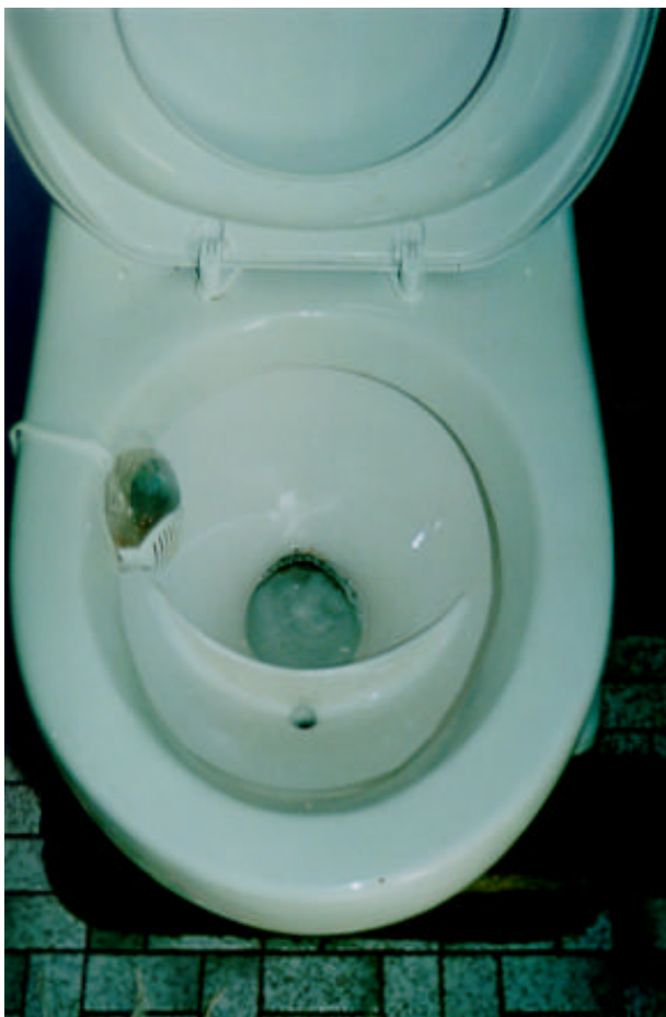
Figur 5.4 Kildesortierende toilet med pedal til aktivering af vakuum og vandskyl.
