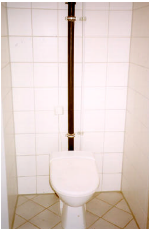
Figur 4.1 Kildesamlende Vakuumtoilet fra et lejlighedskompleks i Hannover. Bebyggelsen indgår i "Öko-Technik-parken" i byen.
