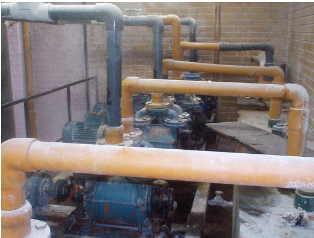
Figur 8.1 Vakuumpumper på Hummingen renseanlæg. Foto: Boye Holm, Rudbjerg Kommune.
