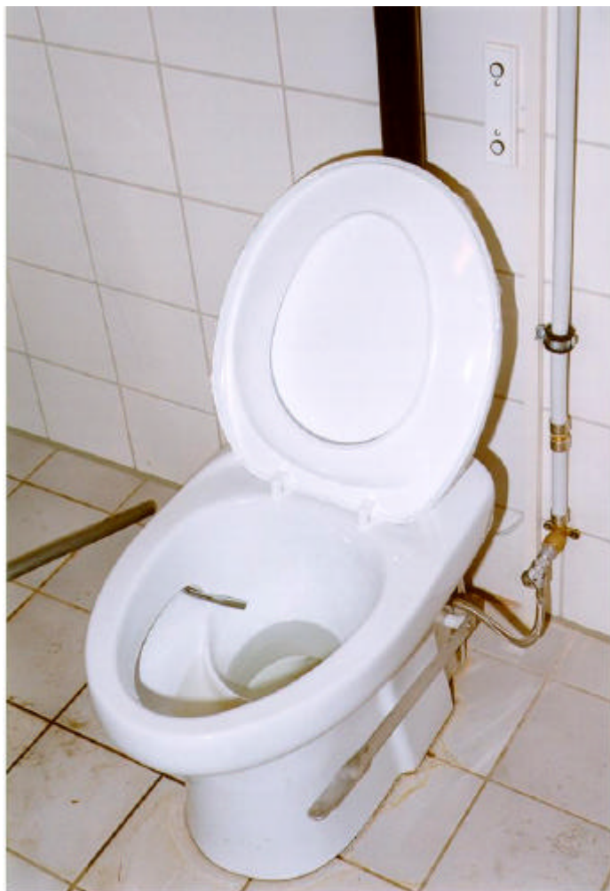
Figur 4.2 Kildesortierende Vakuumtoilet fra "Öko-Technik-parken" i byen, hvor et enkelt toilet er opsat i demonstrationsøjemed.
