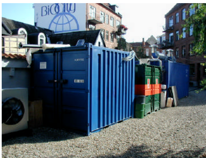
Foto af el-, damp- og maskincontainer.
