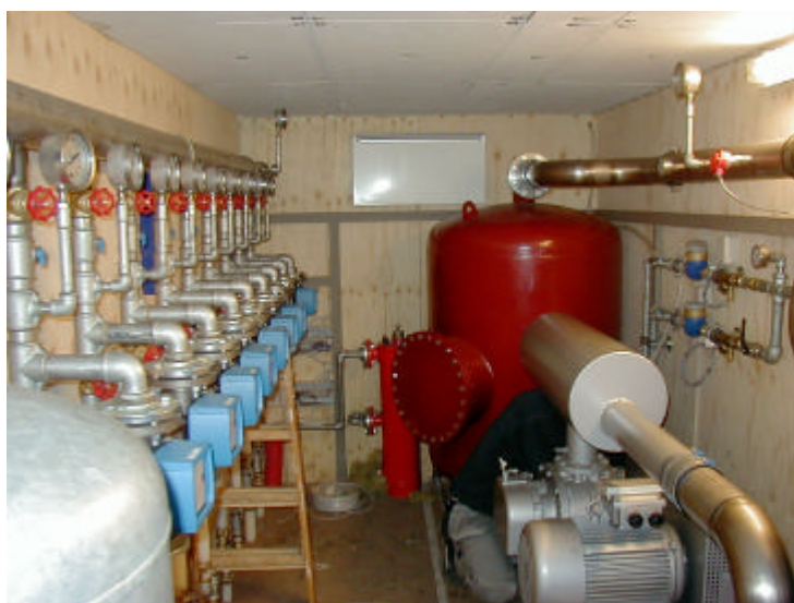
Foto af maskincontainer med manifold, vakuumpumpe, vandudskiller m.m.
