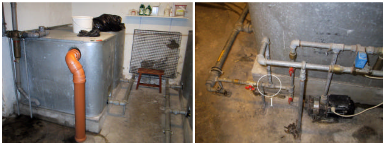
Figur 5.4: Regnvandsanlæg på Ewaldsgade i Århus. Til venstre ses 2 af de ialt 6 regnvandstanke. Til højre ses fejlforbindelsen hvor drikkevandsforsyningen er koblet på regnvandsanlægget. Der skulle have været et frit luftgab.
