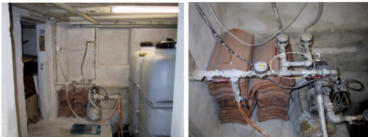
Figur 5.5: Regnvandsanlæg på Klostergade i Århus. Til venstre ses 2 regnvandstanke, samt pumpe og rørforbindelser. Til højre er der zoomet ind på rørforbindelserne og her ses fejlforbindelsen, hvor drikkevandsforsyningen er koblet på regnvandsanlægget.
