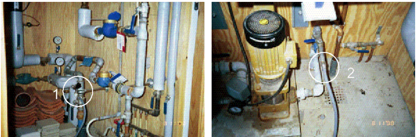
Figur 5.3: Til venstre ses en spulehane med slangeforskrunding direkte forbundet med regnvandspumpens sugledning, Spulehanen monteret før afregningsmåleren. Til højre ses en slangetilslutning på regnvandspumpens sugledning til spædning af pumpen.
