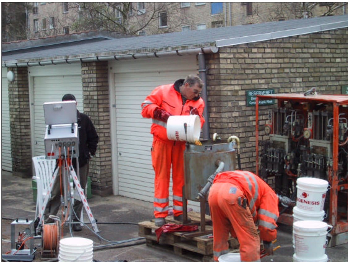
Omhædning af HRC/primer til beholder. Til højre ses stempelpumpen med de 2 kredsløb. Til venstre ses kontrolenhed.
