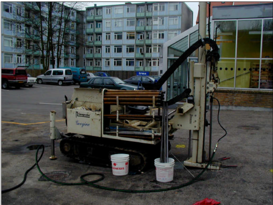
I forbindelse med injektionen holdes borestænger i spande for at undgå spild .
