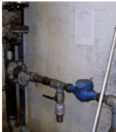
Figur 7.3: Kontraventilen på stikledningen kontrolleres jævnligt. Registrering af kontrol via ophængt skema.
