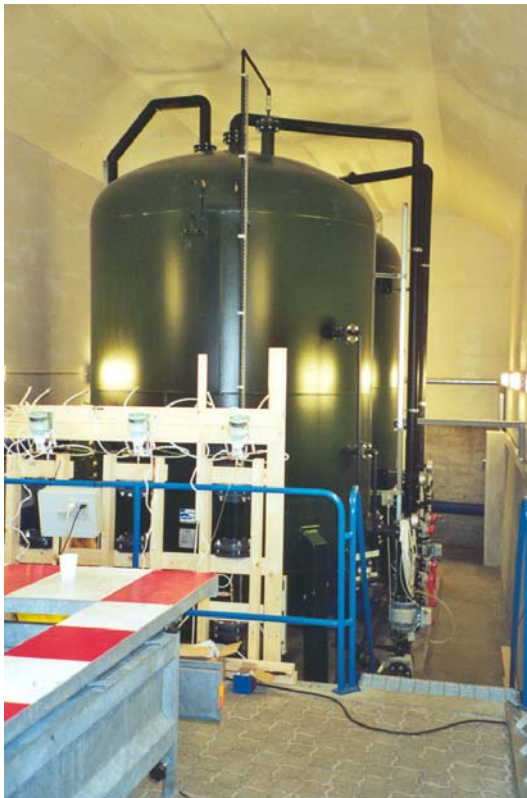
Figur 3.8. Foto af fuldskalaanlægget på Hvidovre Vandværk.
