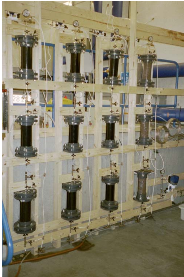
Figur 3.2. Foto af bench-scaleanlægget opsat på Hvidovre Vandværk.
