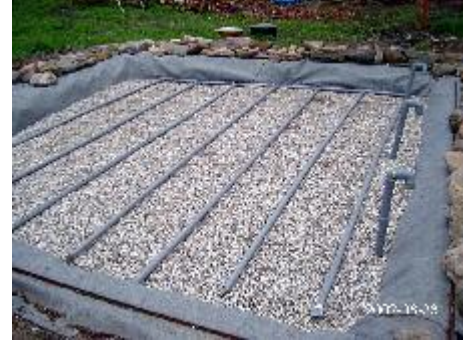
Figur 6. Error! Unknown switch argument. Trykfordelerrør til fordeling af spildevandet på filteroverfladen er udlagt med en indbyrdes afstand på ca. 0,5 meter
