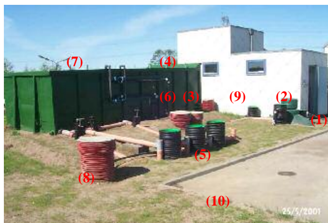
Figur 3.9 (1) Indløbs-pumpe;(2) 2-m 3 trekammer bundfældningstank; (3) Første pumpebrønd; (4) Det store vertikale filter; (5) Tre serieforbundne brønde til binding af fosfor; (6) Anden pumpebrønd; (7) Det lille vertikale filter; (8) Afløbsbrønd med pumpe for recirkulering; (9) Recirkulering til første kammer i bundfældningstanken; (10) Udløb.
