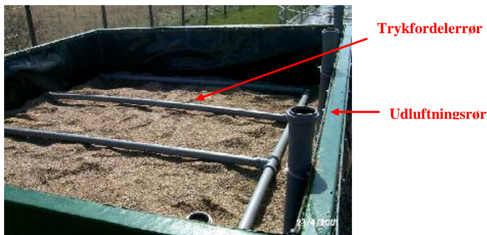
Figur 3.7 Trykfordelerrør udlagt på toppen af filteret. Trykfordelerrørene er senere blevet dækket af et 15 cm isolerende lag af træflis.
