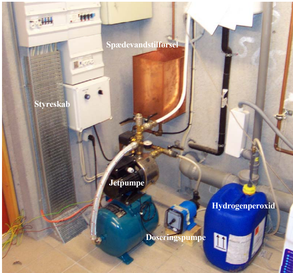
Figur 10. Kemikaliedoseringsanlæg, jetpumpe og spædevandstilførsel.
