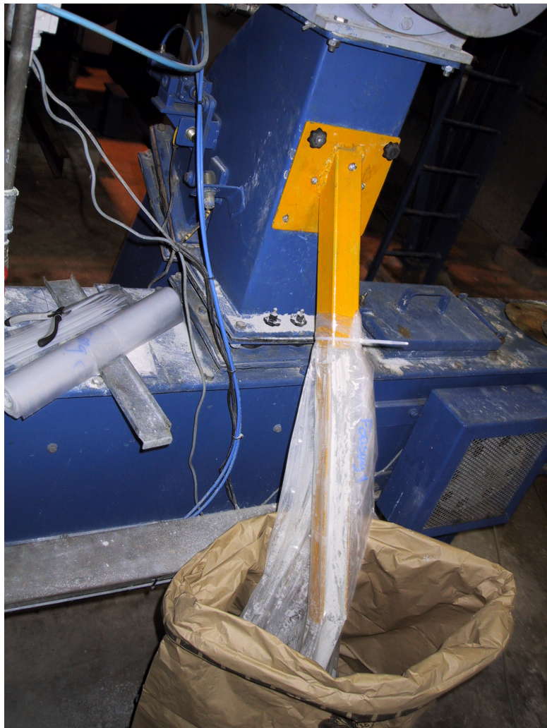
Figur 15 Første prøvetager installeret og i funktion
