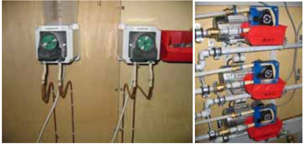
FOTO 4.3 OG 4.4. PERISTALTISKE PUMPER TIL HENHOLDSVIS TILSÆTNING AF DONOR/TRACER OG TIL REINJEKTION.
