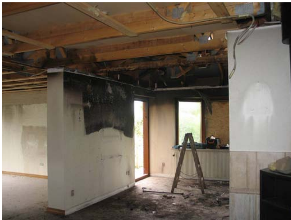
Foto 4: Branden er startet i stuen hvor loftet er brændt ud og hvor håndværkere i første omgang har repareret ødelagte spær.
