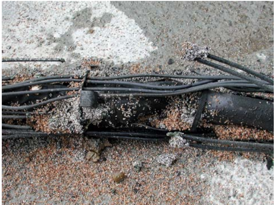
Figur 7.10 Nærbillede af sammenbrudsstedet. De overbrændte varmeelementer ses på billedet, samt det fkol lapsede inderrør og forkullede væv.
