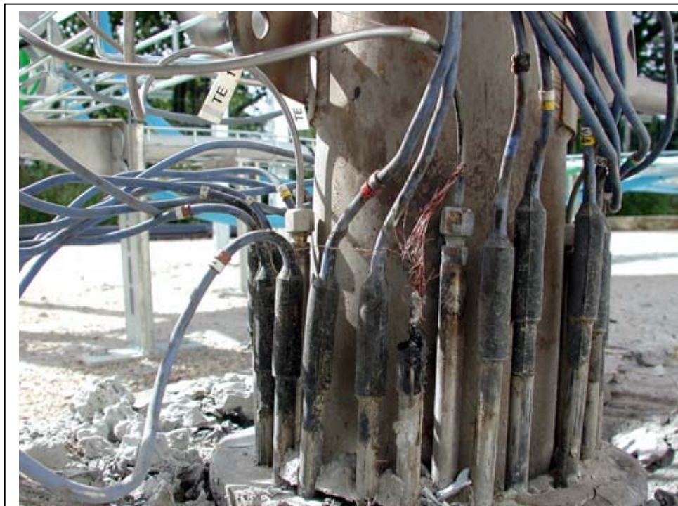
Figur 7.8 Billede af toppen af varmelegemet efter 24 timers drift. De enkelte varmelementers afslutning til kabel ses i billedet. Centralt ses overbrændte kabler.
