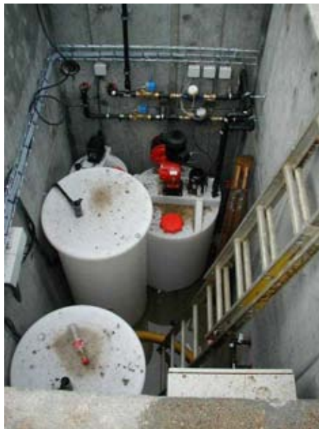
Figur 4.4: Foto, der viser indretning af bygværk med doseringsanlæg.
