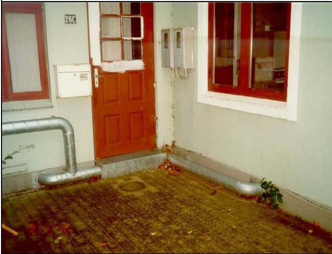
Udendig overjordisk rørføring (stålrør).
