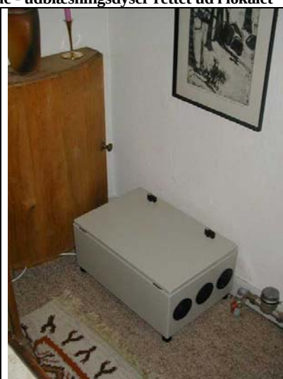
Udblæsningsdyser rettet ud i lokalet
