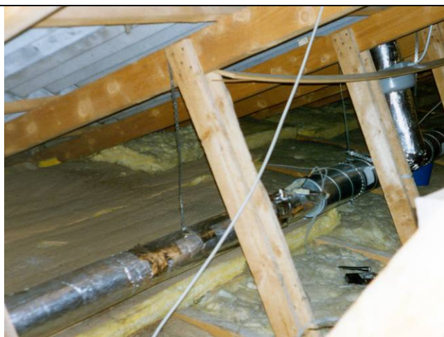
Afkastrør og ventilator ført under tag
