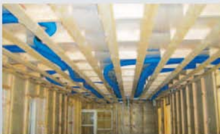
Loftsinstallation, der viser slangernes fleksibilitet.
