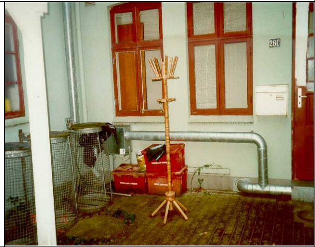
Lyddæmpet boks med ventilator (udvendig på bygningen).
