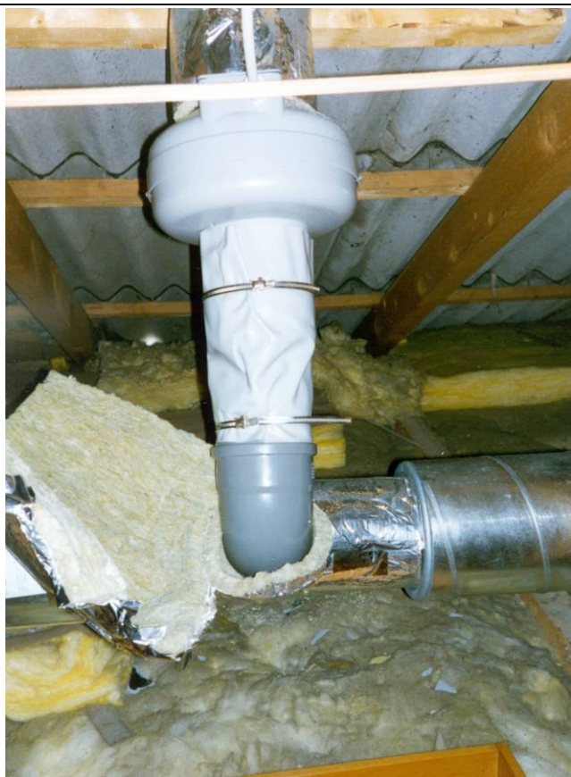
Ventilator på loftsrum
