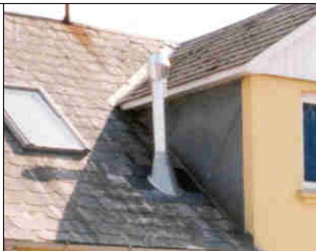
Afkast fra ventilator
