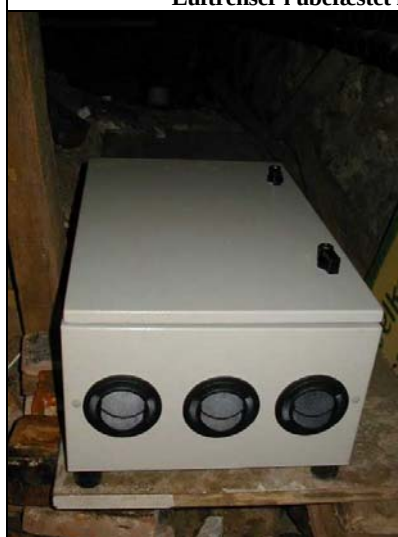
Udblæsningsdyser rettet ud i lokalet
