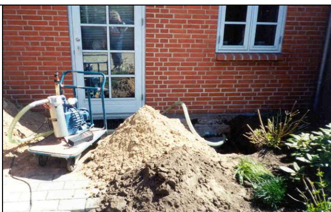
Ventilationstest efter endt installation
