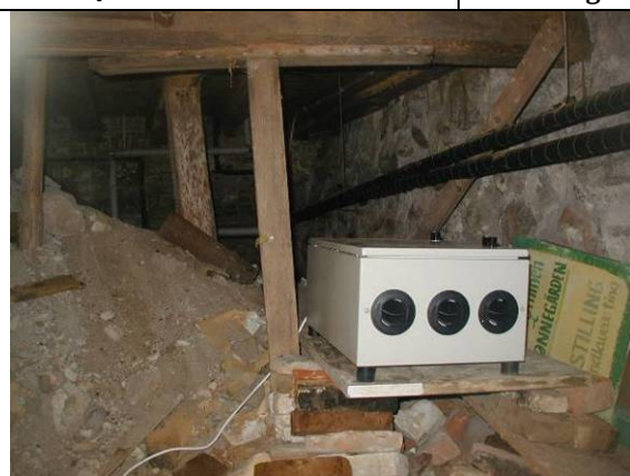
Luftrenser i ubefæstet kælder
