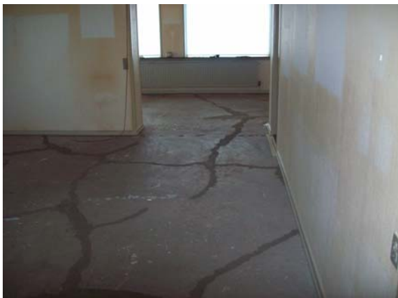
Rum 6: Revner i stuegulv
