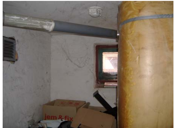
Rum C: Vandvarmer og kloakledning
