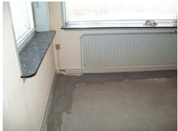
Rum 7: Revner i stuegulv
