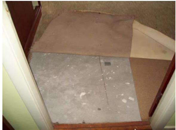
Rum 5: Revne i gulv ved dør
