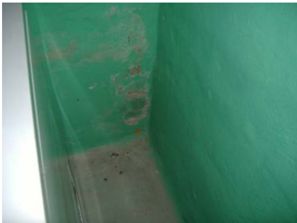
Rum G: Målepunkt 13 (overgang mellem gulv og væg)
