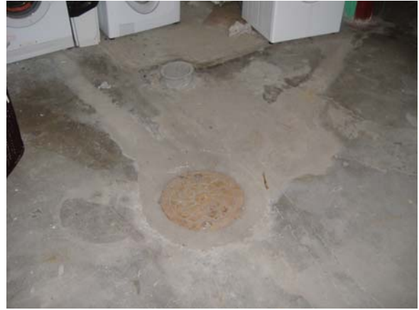
Rum A: Brønddæksel og boring
