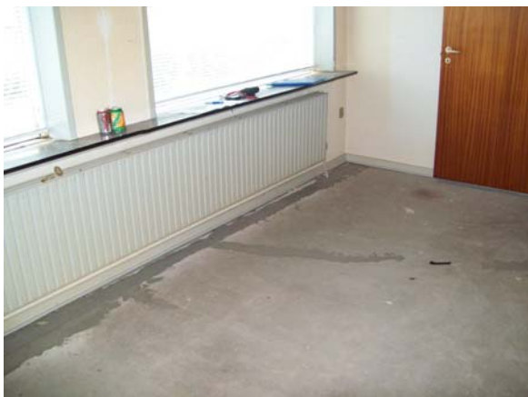
Rum 7: Revner i stuegulv
