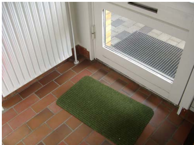
Rum J - revne under dør i baggang
