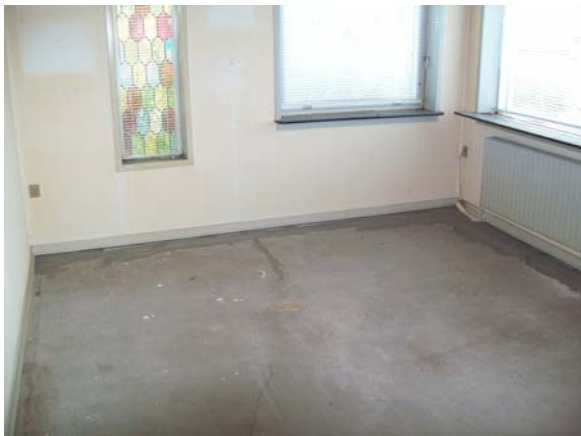
Rum 7: Revner i stuegulv
