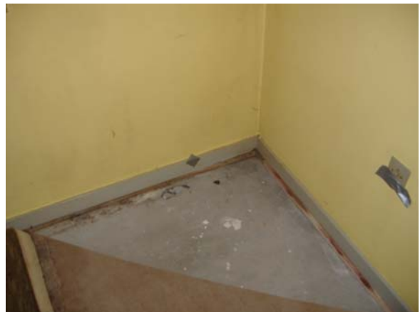
Rum 5: Hul i gulv i hjørne (punkt B)
