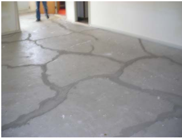
Rum 6: Revner i stuegulv
