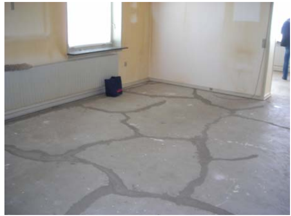
Rum 6: Revner i stuegulv
