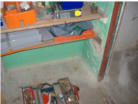
Rum G: Målepunkt 7 (overgang mellem gulv og væg)
