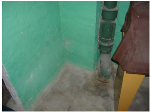
Rum G: Målepunkt 10 (overgang mellem gulv og væg)
