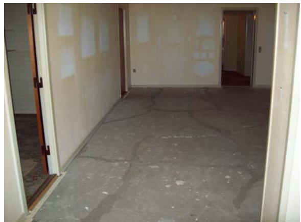
Rum 6: Revner i stuegulv
