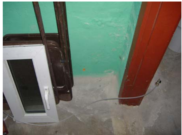
Rum G: Målepunkt 12 (overgang mellem gulv og væg)
