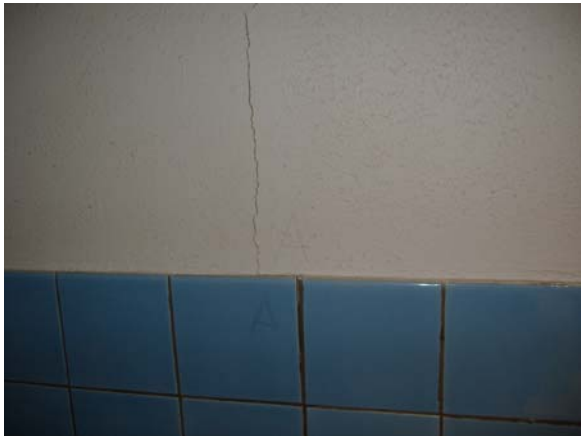
Rum 4: Revne i væg i badeværelse
