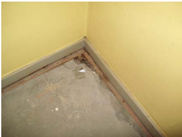
Rum 5: Hul i gulv i hjørne (punkt A)
