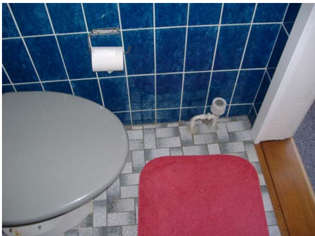
Revne ved overgang mellem gulv og væg i rum C
