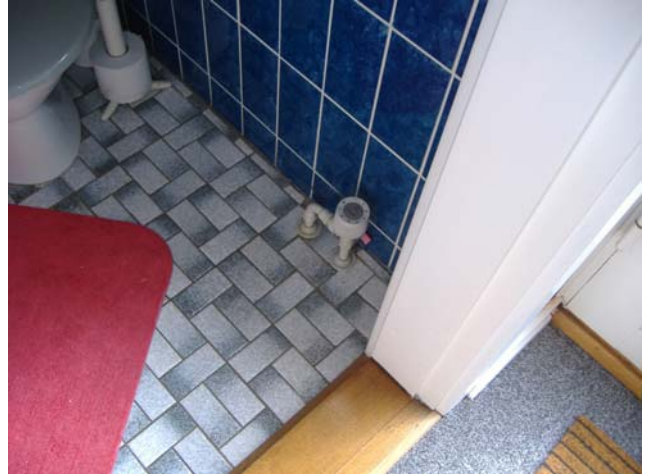
Målepunkt 2 ved revne - rum C
