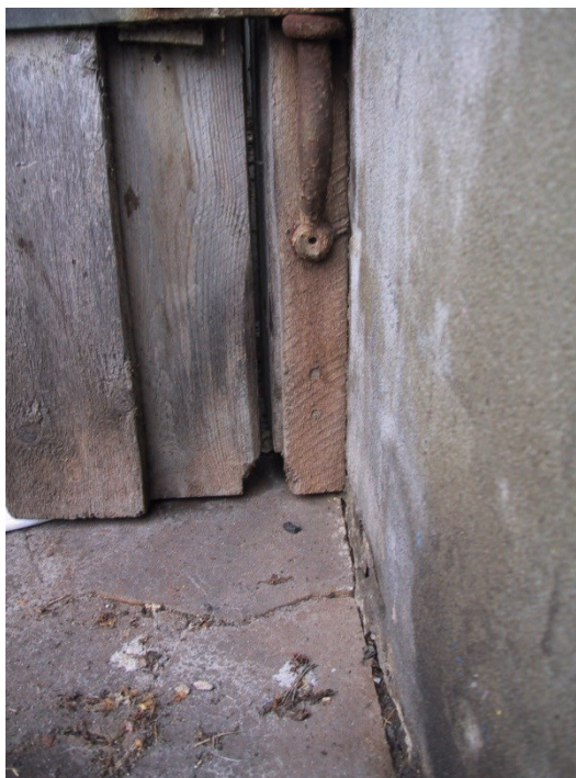
BILLEDE 37 ROTTEHUL I TRÆBEKLÆDNING, HVOR HULLET ER GNAVET UDEFRA.
