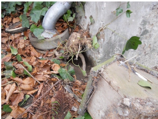
BILLEDE 47 ET ROTTEHUL UDEN JORDFANE PÅ EN BEBOELSESEJENDOM, HVOR DER ER KLOAKERET, ER NORMALT ET TEGN PÅ KLOAKBRUD.
