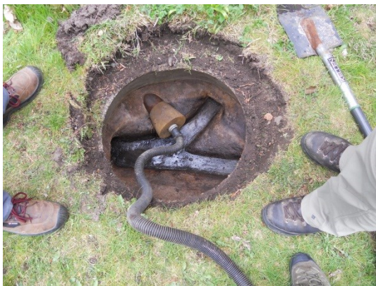
BILLEDE 51 VED MISTANKE OM KLOAKFEJL PÅ EN EJENDOM MED ROTTER SKAL ROTTEBEKÆMPEREN ALTID FORETAGE EN RØGPRØVE AF KLOAKSYSTEMET.
