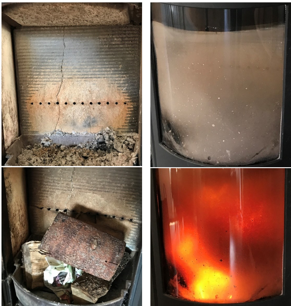
Hus nr. 9.1 Før renovering: Revnet skamolplade, optænding og rudebelægninger
