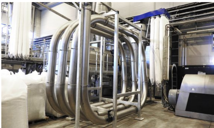
Figur 8-25 Termisk tørremaskine fra B+B
