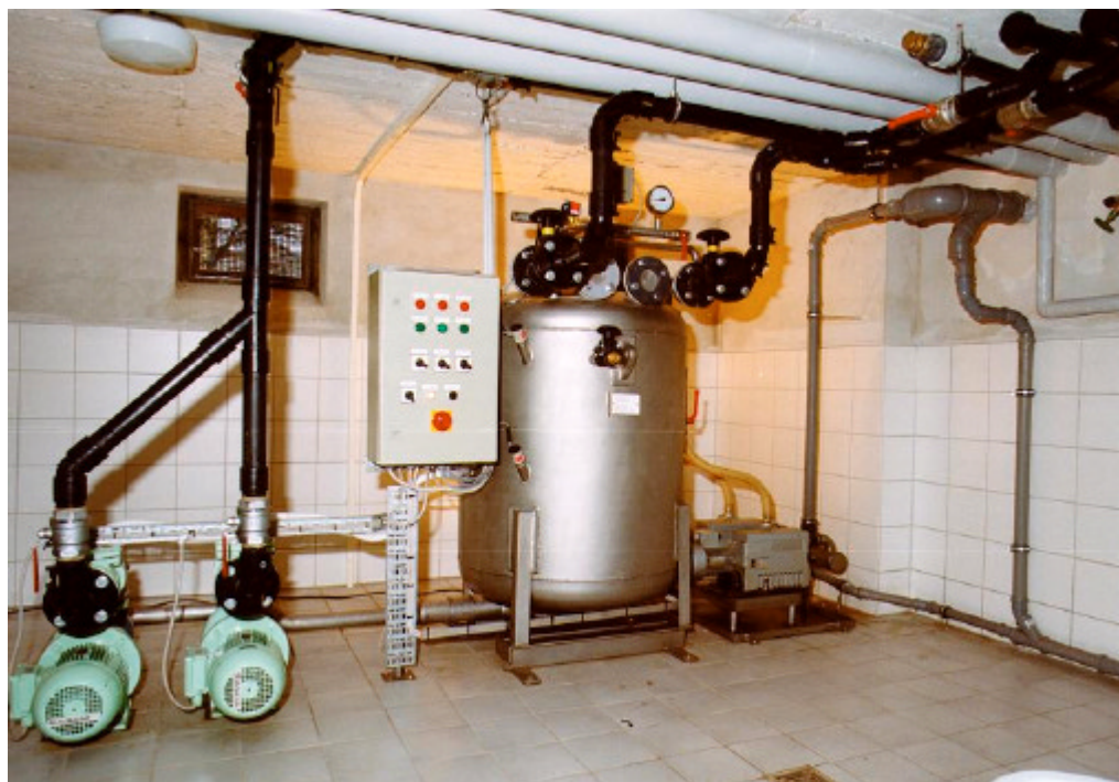
Fig 3.3 Vakuumcentralen i kælderen, Kugelfangtrift 90-96, Hannover
