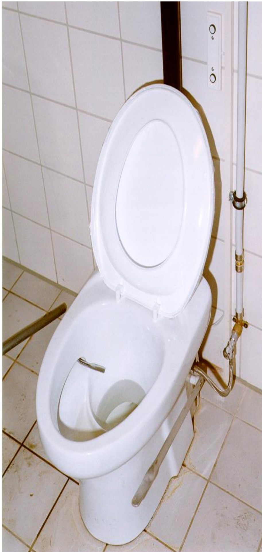
Fig. 3.5 "ECO-VAC" kildesortierende vakuumtoilet med vakuumventil i kælderen Kugelfangtrift 90-96, Hannover
