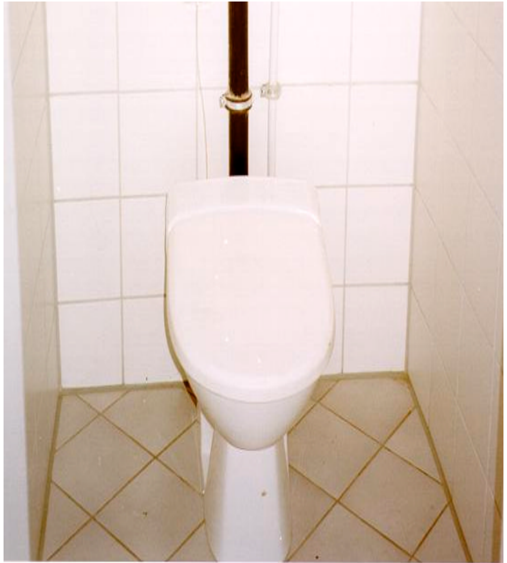
Fig. 3.4 "EVAC 90 Silent" kildesamlende vakuumtoilet i kælderen Kugelfangtrift 90-96, Hannover
