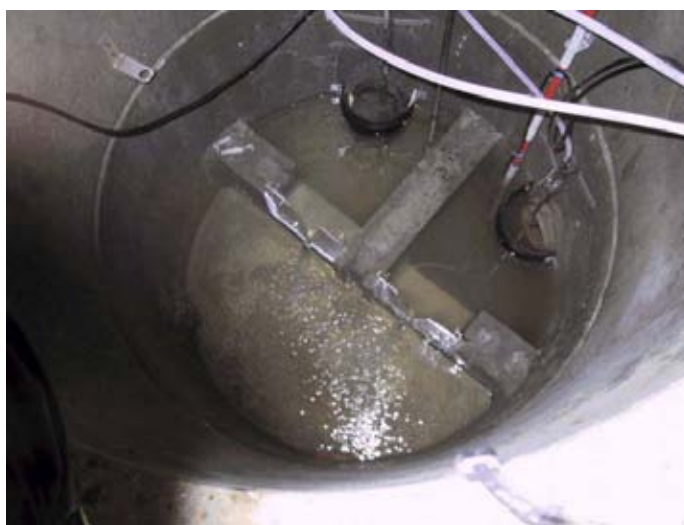
Figur 8 Kamre i drænbrønd. Billedet af drænbrønden viser placering af prøvetagningsudstyr og opdeling i 2 kamre
