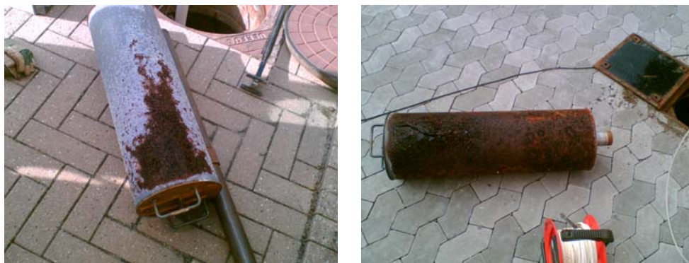
Figur 19: Eksempler på rustangreb på kulfiltre.
