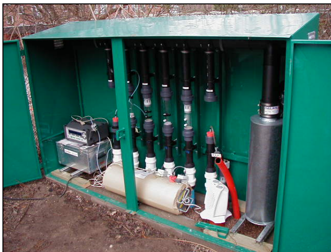
Figur 11: Foto af skab til ventilationsledninger tilsluttet fælles manifold over terræn. Til venstre er en INNOVA 1312-A gasmåler placeret i forbindelse med monitoring af gaskoncentrationer. Til højre ses kulfiltret og i bunden ses et nyt kulfilter.
