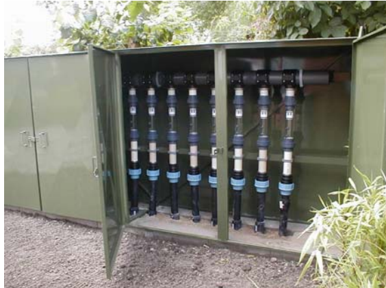
Figur 26: Ventilationsledninger i fælles manifold på Virumvej.
