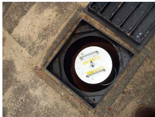
Figur 9: Foto af tørbrønd med kulfilter.
