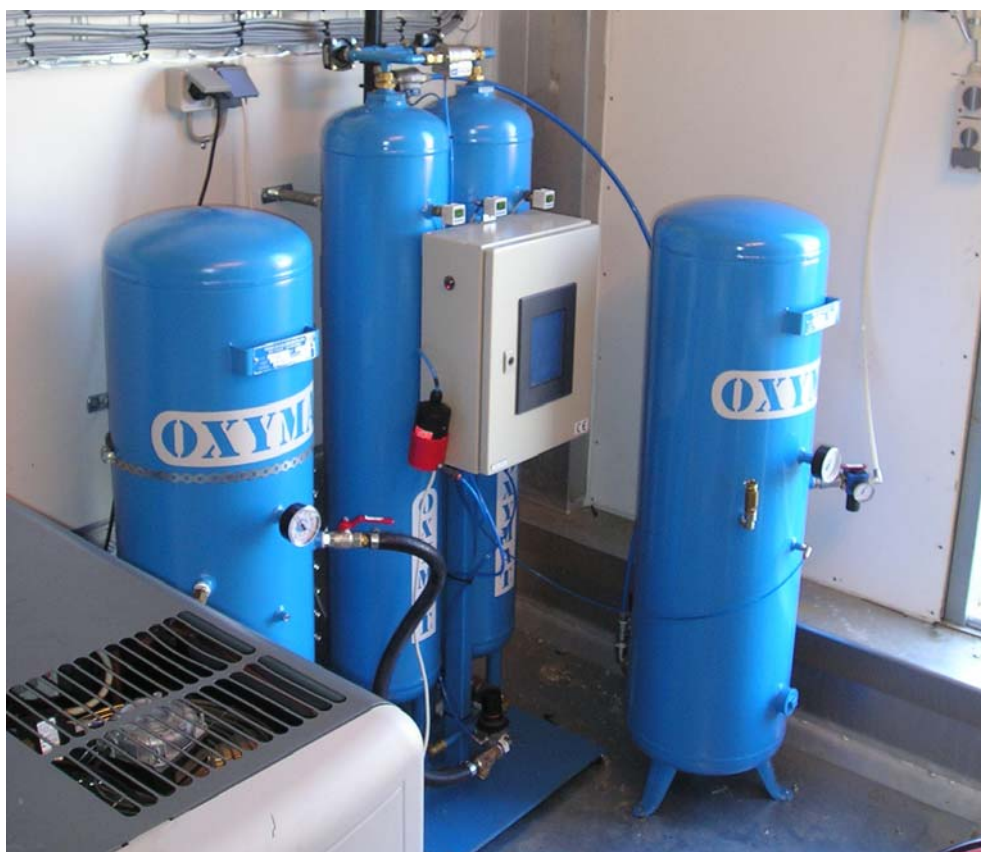
Figur 3.3 OxyMat 20 LE uniten i vandbehandlingsanlægget på Østre Gasværk
