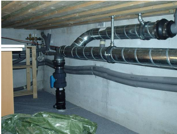
F9: Ventilationsboring 1, ud, samt rørføring, prøvetagningshane og kugleventil
