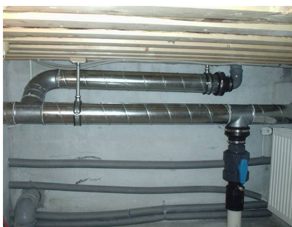
C6: Ventilationsboring 2, ud, samt rørføring, prøvetagningshane og kugleventil
