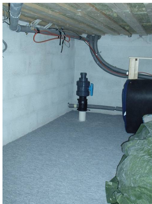
F8: Ventilationsboring, ind, færdigetableret.
