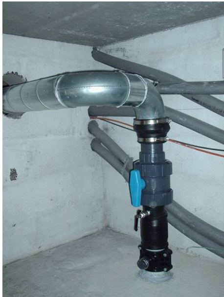
F11: Ventilationsboring 3, ud, samt rørføring, prøvetagningshane og kugleventil
