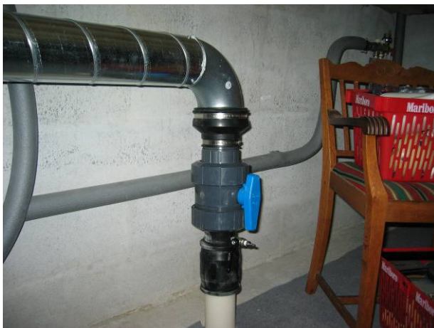
C7: Ventilationsboring 3, ud, samt rørføring, prøvetagningshane og kugleventil
