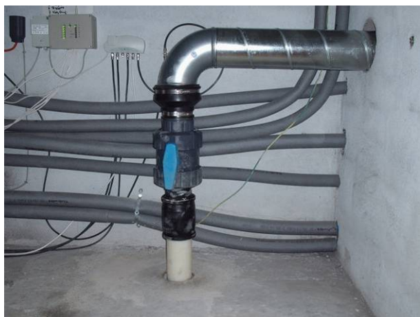
C5: Ventilationsboring 1, ud, samt rørføring, prøvetagningshane og kugleventil
