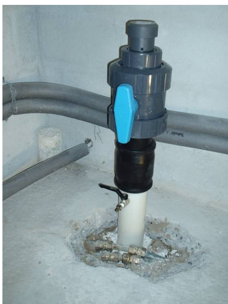
F5: Ventilationsboring med prøvetagningshane, kugleventil og kontraventil
