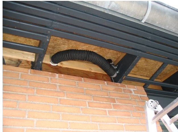
F12: Afkast fra ventilationsboringer i krybekælder
