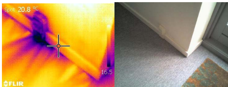
Figur 6.40: Tydelige luftstrømme mellem fodpanel og gulv samt stikkontakt. Nørregade, Køge.
