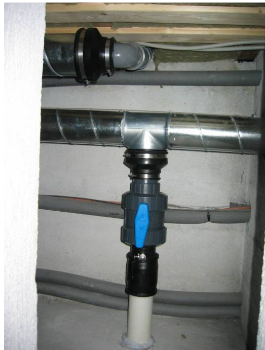
A6: Ventilationsboring 2, ud, samt rørføring, prøvetagningshane og kugleventil
