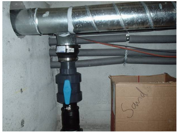
F10: Ventilationsboring 2, ud, samt rørføring, prøvetagningshane og kugleventil
