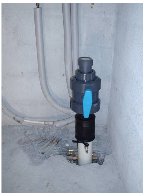
F7: Ventilationsboring med prøvetagningshane, kugleventil og kontraventil
