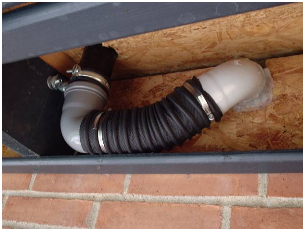
C8: Afkast fra ventilationsboringer i krybekælder
