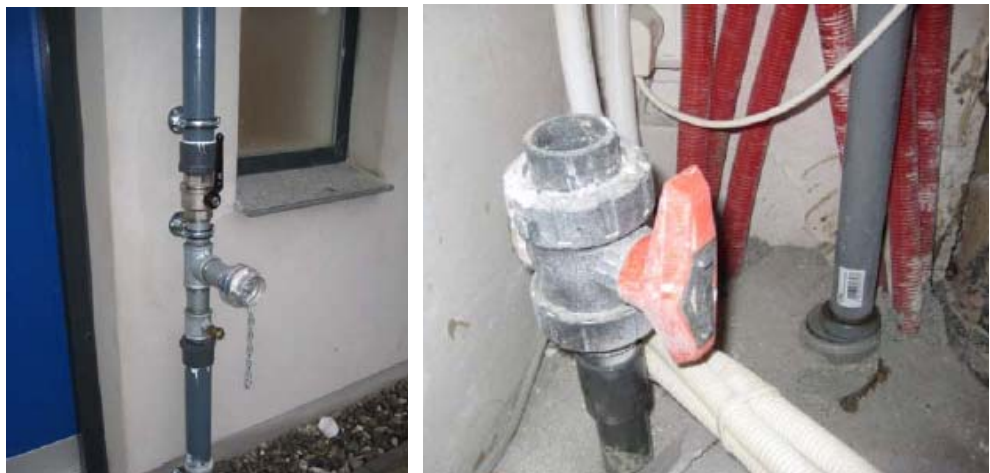
Figur 6.12: Opføringsrør fra dræn til vindhætte på tag samt monteringsstuds gennem gulv placeret i teknikskab.
