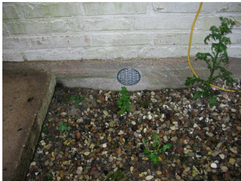
Figur 6.18: Ventilationsrist i fundament for udluftning af krybekælder. Birkevænget i Slagelse.
