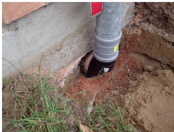
F16: Rørføring gennem fundament ved svanehals
