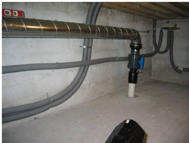
A7: Ventilationsboring 3, ud, samt rørføring, prøvetagningshane og kugleventil
