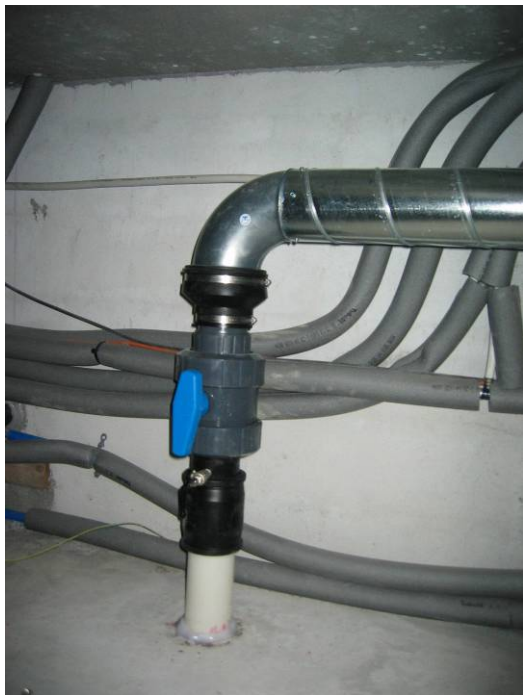
A5: Ventilationsboring 1, ud, samt rørføring, prøvetagningshane og kugleventil
