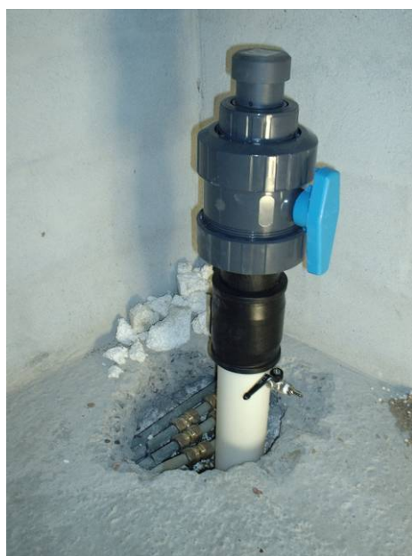
F6: Ventilationsboring med prøvetagningshane, kugleventil og kontraventil
