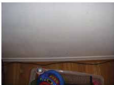
#15 Indtrængning ved fodliste (stuen).
