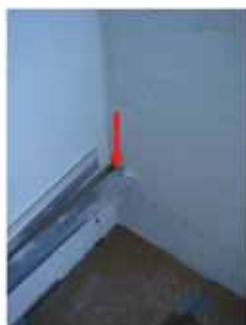
#11 Rørgennemføring tilhørende kondensaflob (rødt niveau).
