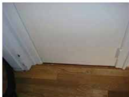
#18 Indtrængning ved dør til kælderen (gangen i stueetagen).
