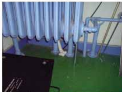
#74: Der blev målt med detektoren ved rørføringerne, der går gennem betondækket. Betondækket udgør etageudskillelsen mellem en del af kælderen og tidligere rum med rensemaskine.
