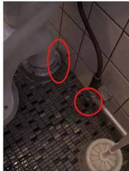
#28 Test 5: Indtrængning bag faldstamme til WC og ved gl. vandrør (rødt niveau).
