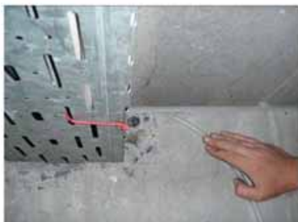
#29 Test 5: Udledningsområde ved kabelbakkegennemføring i krybekældervæg under sætningsrevne i lejl. 13B.
