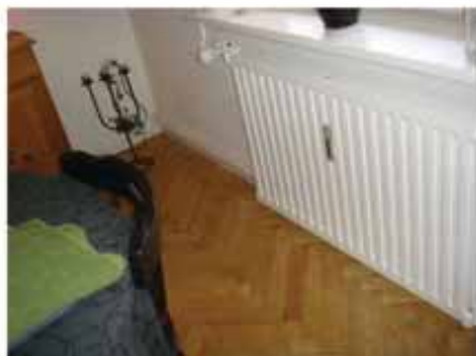
#15: Område i 1. th. over sætningsskade i frisørsalon med positivt signal.
