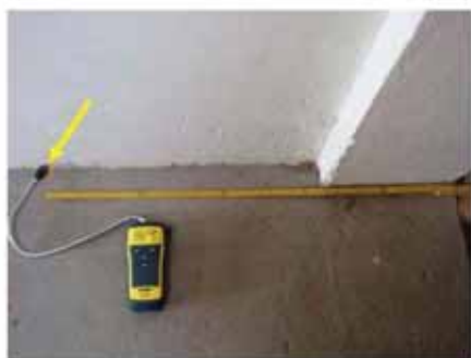
#15 Gasindtrængning ved stobeskel imel-lem garagegulv og skillevæg imellem garage og bryggers (gult niveau).
