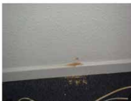
#12: Kontrolpunkt i væg i 1. th. i soveværelse.
