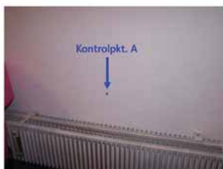
#3 Test 2: Kontrolpunkt A i den østlige bagvæg (hulmur) i forretningslokalet.
