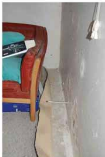
#6 Kontrolpunkt 6 og støbeskel med kraftig gasindtrængning (værelse).
