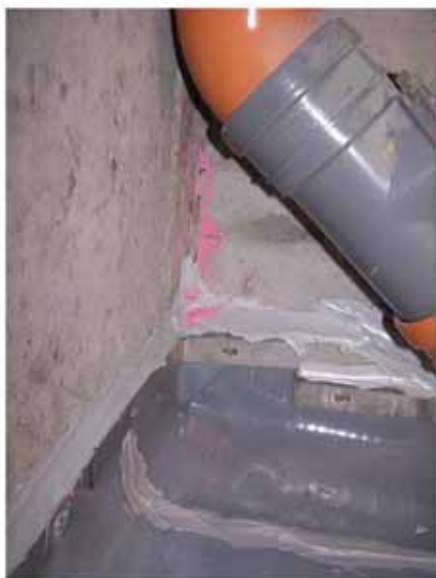
#21 Test 1: Indtrængning i vægsamling bag faldstamme (rødt niveau).
