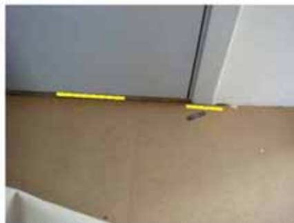
#14 Gasindtrængning ved stobeskel under dør til badeværelse (gult niveau).
