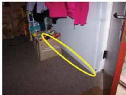
#36 Test 7: Indtrængning langs støbeskel ved sydlig ydervæg ved siden af døren og under trappen (gult niveau).
