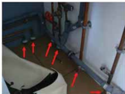
#9 Gasindtrængning ved rørgennemføringer – på bagsiden (rødt niveau).
