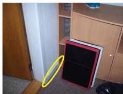
#34 Test 7: Indtrængning langs støbeskel ved skillevæg imellem pulterkammer og trappeopgang (gult niveau).
