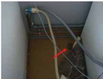
#3 Kontrolpunkt MP1b. Gasindtrængning konstateret omkring poreluftstationen (rødt niveau).
