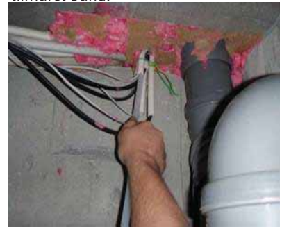
Figur 3.14: Spredning fra krybekælder til lejligheder i stueetage og på 1. sal via elektrikerrør.
