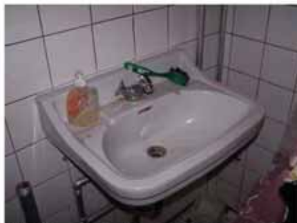
#20 Baggrundsudslag (rødt niveau) ved håndvask i bryggers (Test 5).
