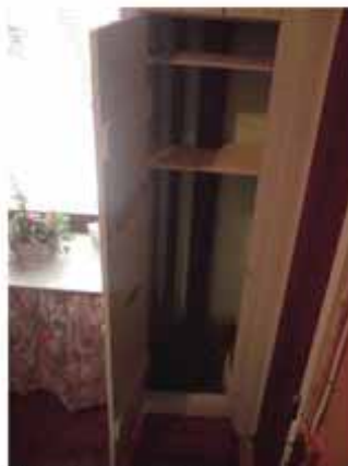
#76: Der blev målt med detektoren ved rørforinger i bagtrappen.
