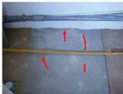
#10 Gasindtrængning ved lappet poreluft-hul, stobeskel og svindrevne (rødt niveau).
