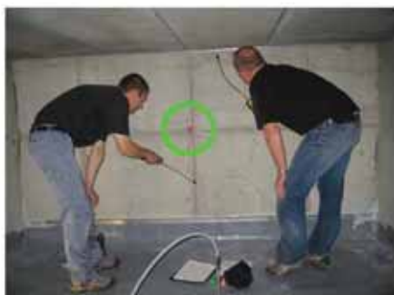
#27 Test 4: Der er ikke konstateret indtrængning ved fuger, eller ved støbehuller eller i øvrige punkter på gulv eller væg (grønt niveau).
