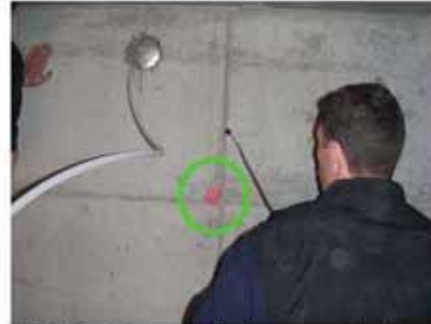
#26 Test 3: Der er ikke konstateret indtrængning ved støbehuller lukket med rødt PU-skum, eller i øvrige punkter på væggen (grønt niveau).
