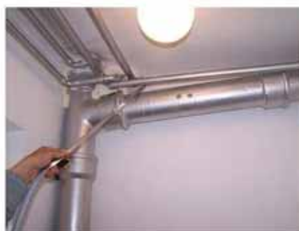
#12 Test 9: Udledning af sporgas ved loft i stueetagen. Her ved tætnede rørgennemføringer på WC i stueetagen.
