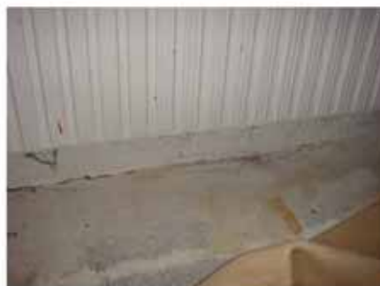
#12 Støbeskel under radiator (værelse).
