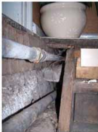
#11: Fra sporgasforsøg: Rørføringer som leder ind til rørgennemføringer syd for kælderlem.
