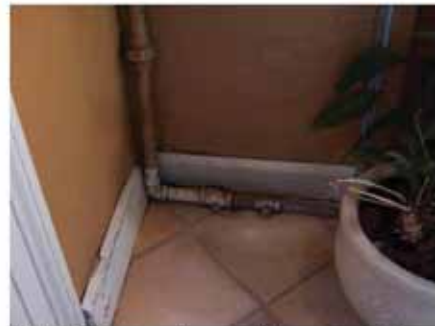
#10: Fra sporgasforsøg: Rørgennemføring syd for kælderlem hvor der kunne detekteres sporgas.
