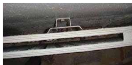
Figur 3.7: Indtrængning ved radiatorophæng på kældervæg.
