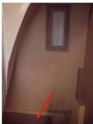
#77: Der blev målt med detektoren i badeværelse (1. sal tv.), der har vindue ud til bagtrappen. Skab med rørforinger er under badeværelset.
