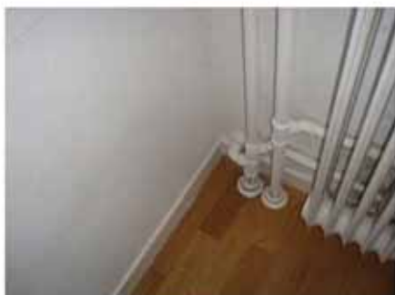
#17 Indtrængning ved radiatorrør (gangen i stueetagen).
