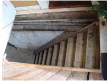
#2: Før tætning: Lem/trappe ned til kælder.
