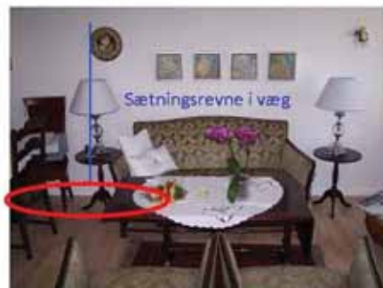
#28 Test 5: Område omkring sætningsrevne i væg (lejl. 13B), hvor der er konstateret indtrængning af sporgas langs fodliste (rødt niveau).
