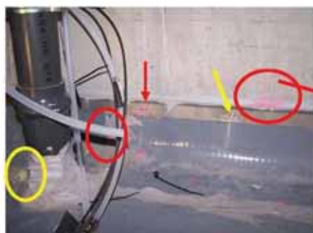
#17 Test 1: Indtrængning igennem fuge ved overlappende membranbaner og klemskinne samt skruehuller ved klemskinne (gult og rødt niveau).
