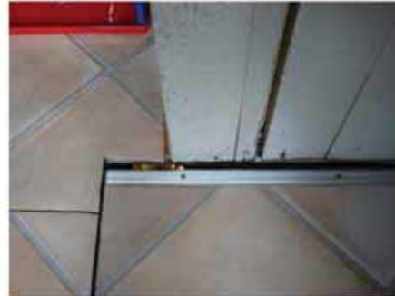
#8: Før tætning: Sprække ved kælderlem.
