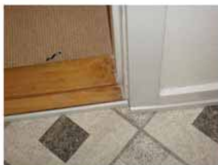
#18: Punkt ved dørrin i 1. th umiddelbart over sætningsskade i fotohandler, med positivt signal.
