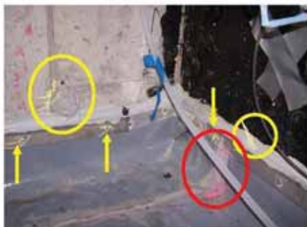
#19 Test 1: Indtrængning igennem fuge og skruehuller ved klemskinne, samt omkring fuge ved væghul (gult niveau) og fuge ved overlappende membranbaner (rødt niveau).
