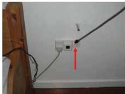
#36 Test 6: Indtrængning af sporgas via telerestik i soveværelse i lejlighed 13G (rødt niveau).
