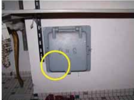
#25 Test 5: Indtrængning i det venstre forreste hjørne indeni bunden af skorstenen (gult niveau).
