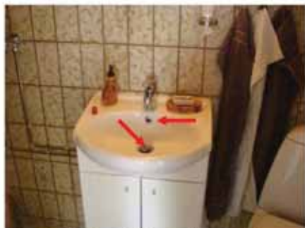
#7 Håndvask på badeværelse med baggrundsudslag (rødt niveau).
