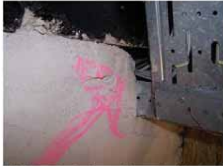
#23 Test 1: Indtrængning ved kabelgennemføring imellem krybekælder og teknikrum (rødt niveau).
