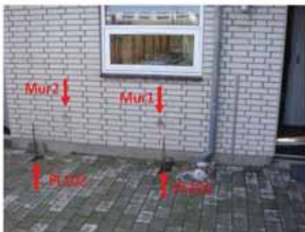
#5 Poreluftstationer PL101 og PL102, og Mur1 og Mur2.
