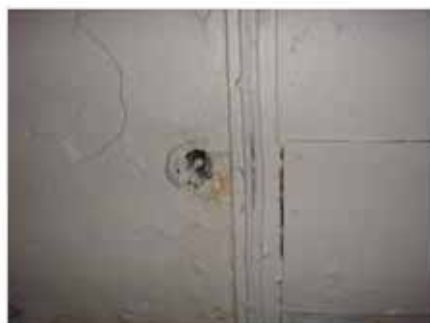
#10 Kabelgennemføring i væg (værelse).
