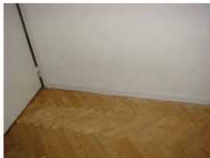
#14: Område i 1. th. over sætningsskade i frisørsalon med positivt signal.
