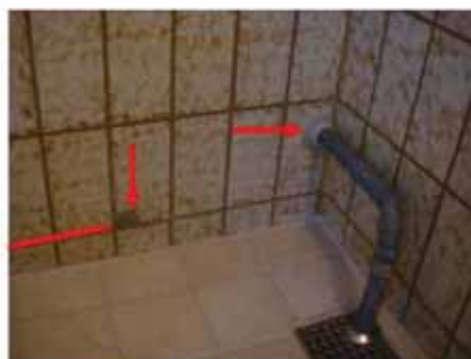
#12 Rørgennemføring tilhørende kondensaflob, fuget hul og flisefuge (rødt niveau).
