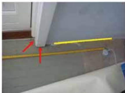
#13 Gasindtrængning ved dørkarm til teras-sedør (rødt niveau) og stobeskel, yder-mur (gult niveau).
