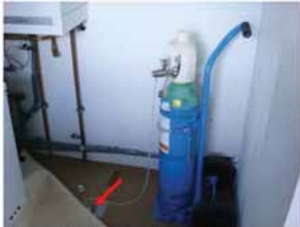
#1 Udlledning af sporgas i MP101. Gasindtrængning konstateret omkring poreluftstationen (rødt niveau).
