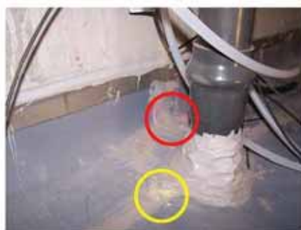
#16 Test 1: Indtrængning igennem fuge ved overlappende membranbaner (gult og rødt niveau).
