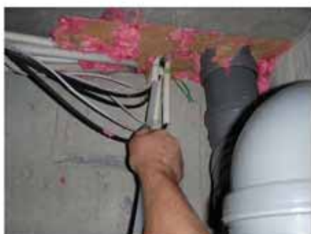
#31 Test 5: Udledningsområde ved loftsgennemføring under kabelskab i lejl. 13B.
