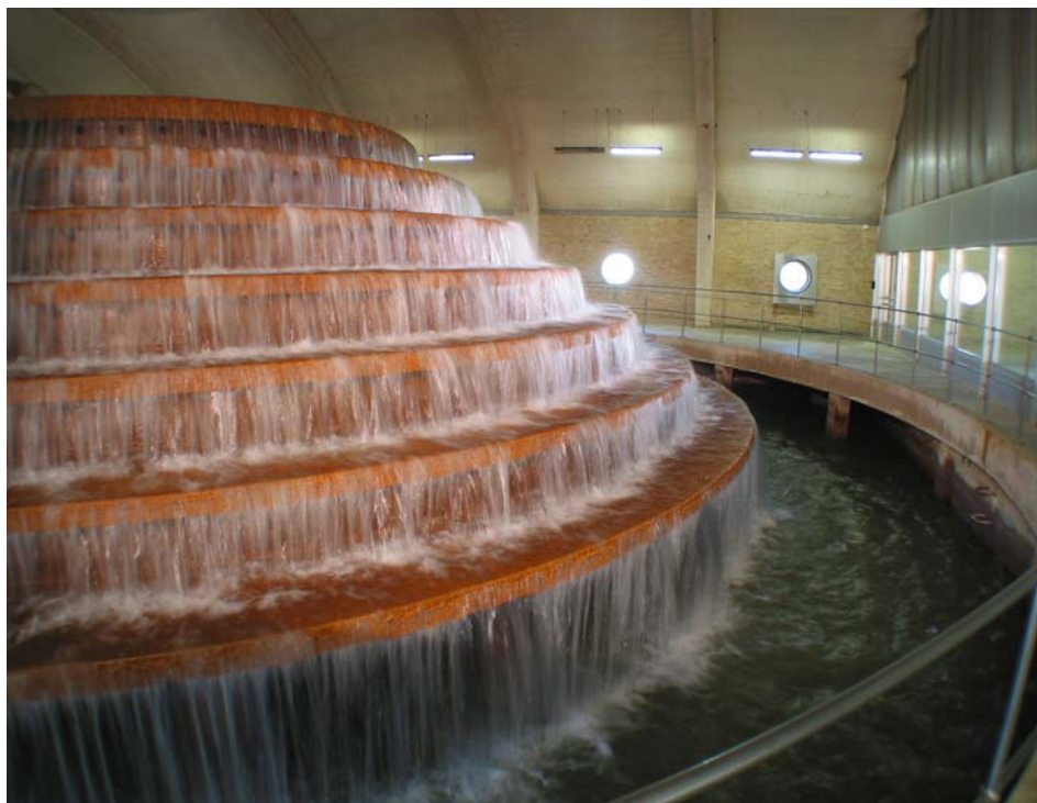
Iltningsstrappe på vandværk. Foto: Region hovedstaden.
