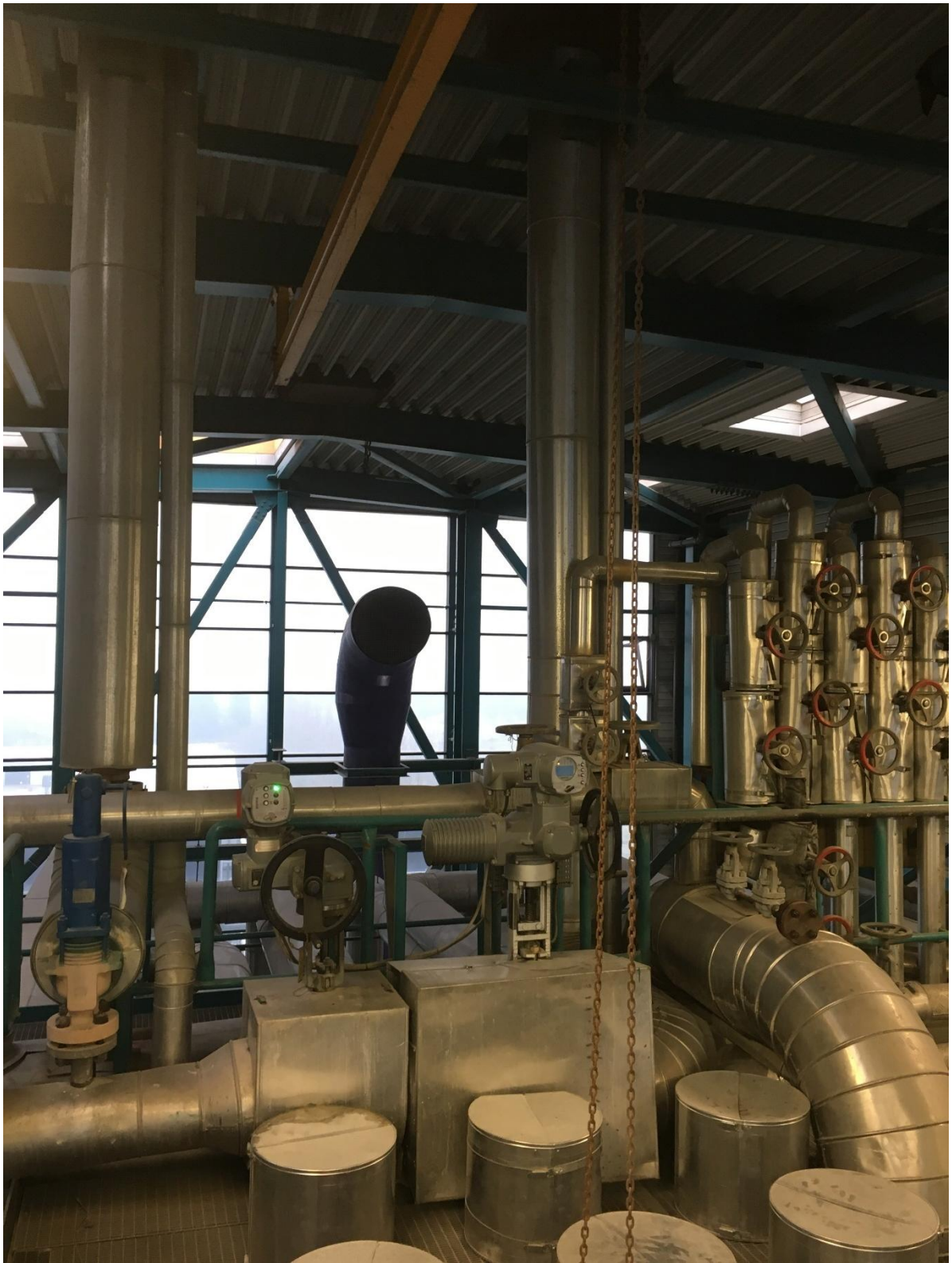
Figur 25. Opstartsventilen placeret under tag i ovnhallen.
