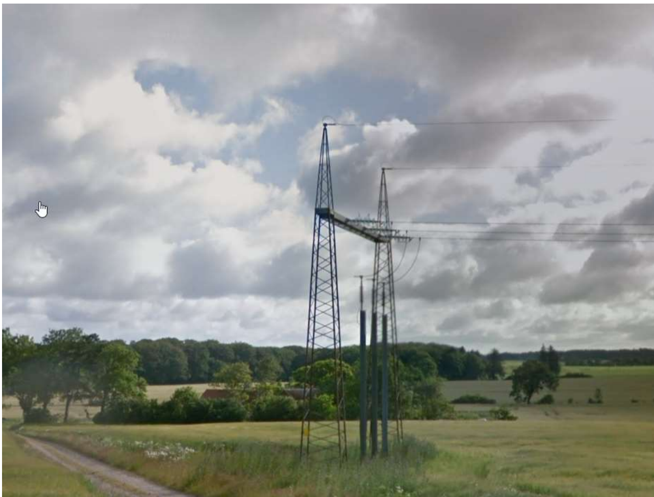
Figur 10-12 Kabeovergang og endetræksmast
