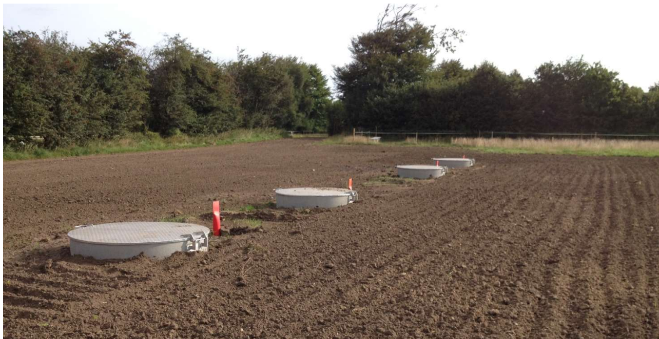
Foto 5-1 Eksempel på teknikbrønde ved fire parallelle kabelsystemer. Ved siden af teknikbrøndene står røde markeringsstandere. Placering og behov for markering vil være en konkret vurdering i de enkelte tilfælde. Der er en brønd for hvert kabelsystem.
