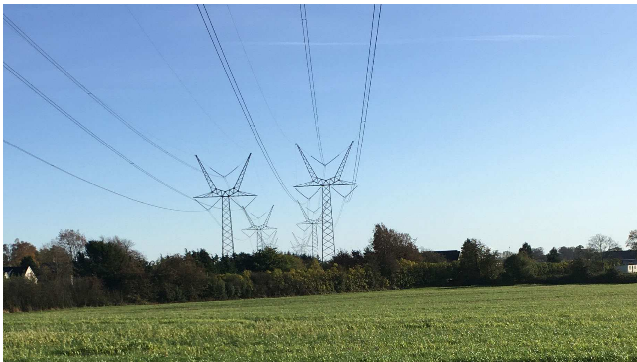
Figur 5: I midten af billedet mast nr. 196 set fra mast nr. 195. Masten er formet som et Y – deraf navnet Y-mast. Udtjente master skiftes med en tilsvarende ny Y-mast. Masterækken til venstre er den nordlige luftledning, som ikke er omfattet af projektet.
