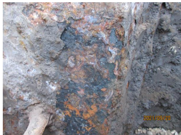
Figur 4-5: Spunsens overflade uden flyveaske. Rustflager kan ses flere steder på overfladen.
