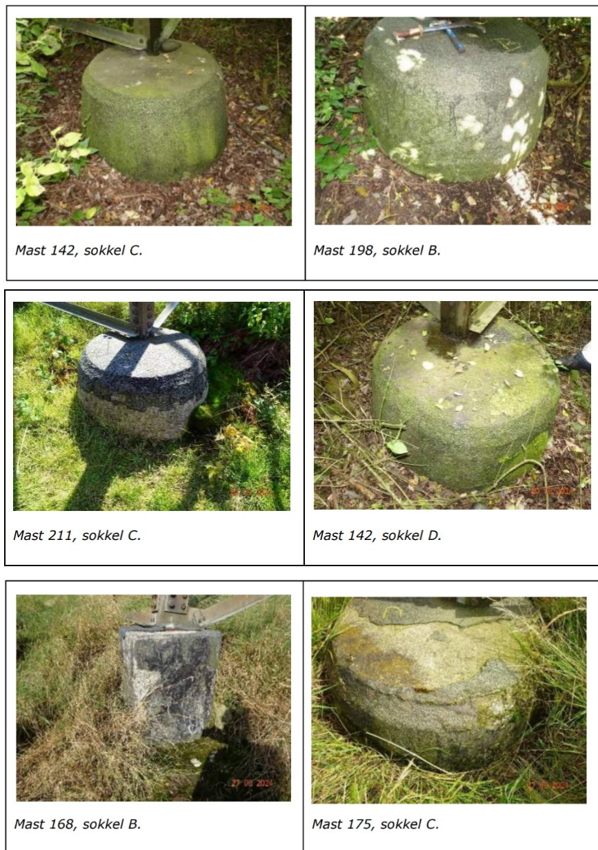
Figur 4-9 To eksempler på sokler i tilstandsklasse 0 (øverst), tilstandsklasse 2 (i midten) og tilstandsklasse 3 (nederst). Tilstandsklasse 2 er den mest almindelige tilstandsklasse og gælder for knap 75 % af soklerne.
