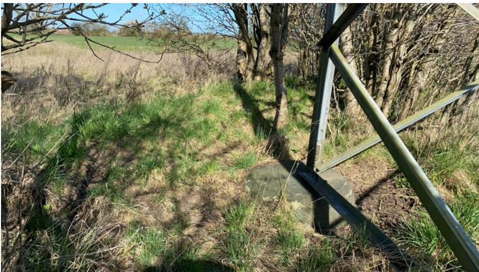
Figur 10-8 Den nærmeste sokkel på mast 192 står lige øst for jorddiget, som ikke er gennembrudt.
