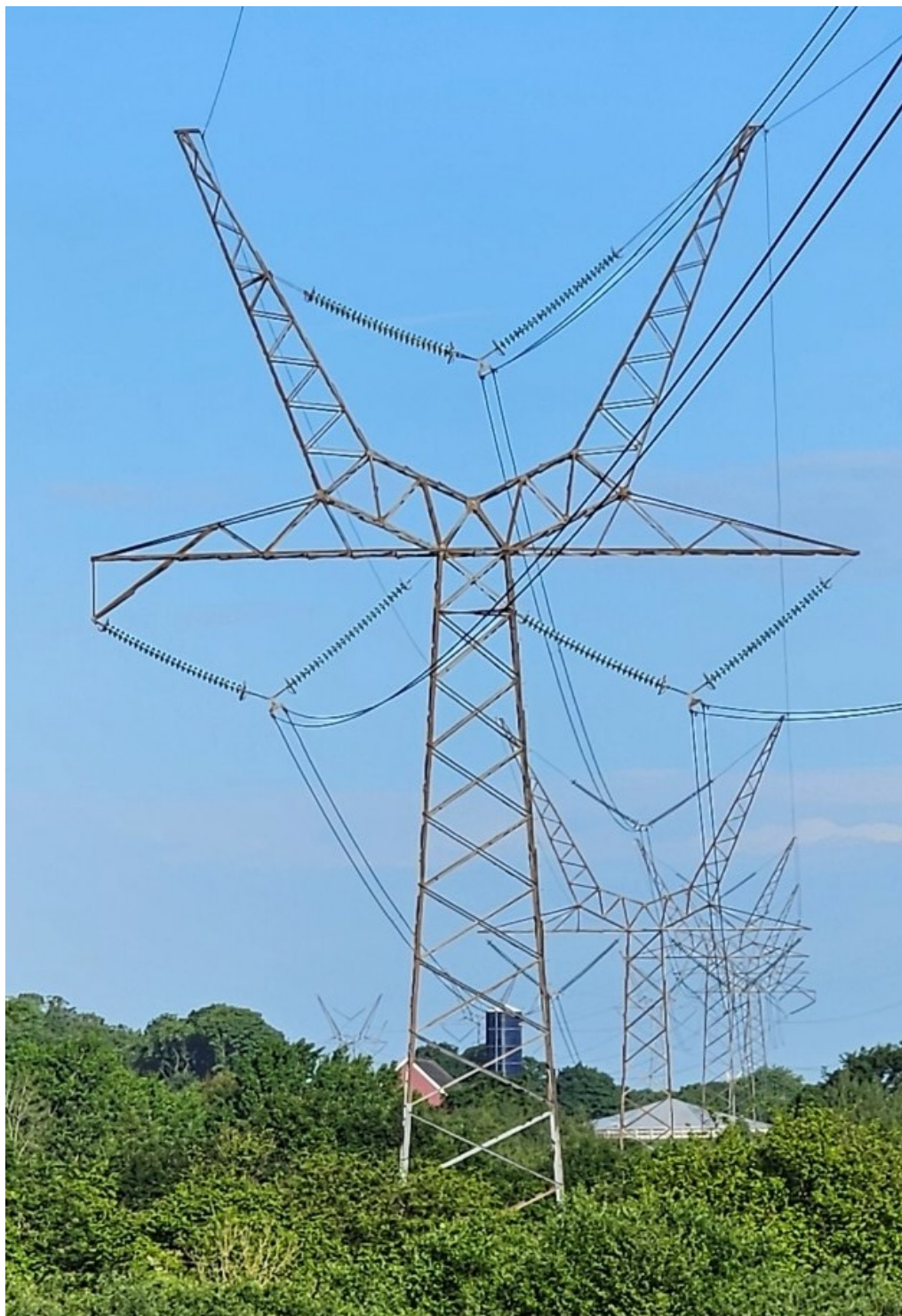
Figur 1-1 400 kV-luftledningsanlægget mellem Kauslunde og Fraugde. Mast 132 i forgrunden, set fra Bogensevej mod vest.
