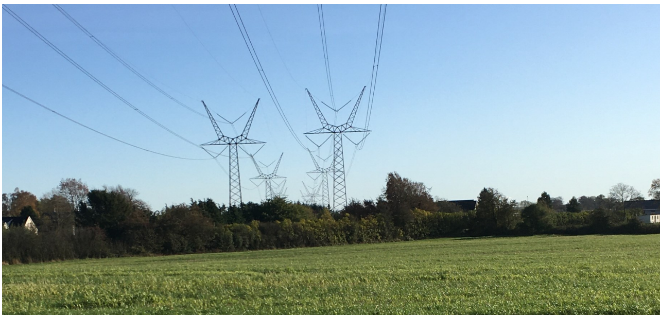
Figur 4-11 I midten af billedet mast nr. 196 set fra mast nr. 195. Masten er formet som et Y – deraf navnet Y-mast. Udtjente master skiftes med en tilsvarende ny Y-mast. Maste-rækken til venstre er den nordlige luftledning fra 1990, som ikke er omfattet af projektet.
