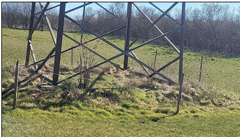
Figur 8-9 Mast 125 står på en hårdt græsset hestefold, ca. 20 meter fra 4Sø13. Fra Swecos besigtigelser i april 2025.
