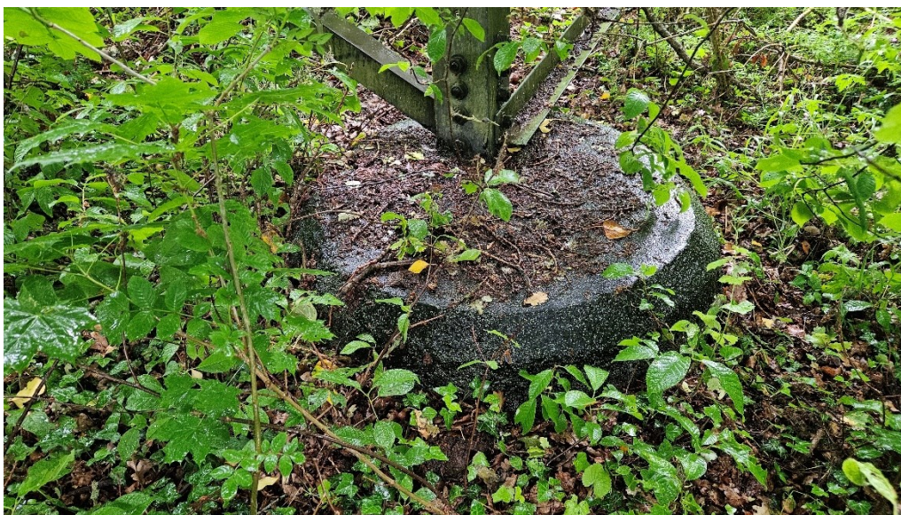
Figur 4-6 Sokkel med asbest. Den sorte overfladebehandling (fugtspærre) er synlig, her påført på hele soklen.
