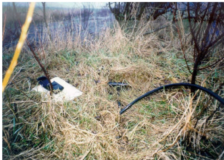
Figur 14.5: Et problem har været overjordisk tilledning via membrandrypslanger, der stoppede til eller blev gnavet i stykker af gnavere.
