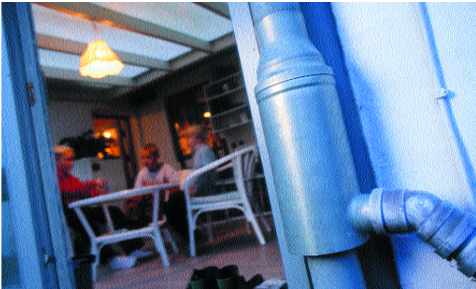
Tagedløb med indbygget filter, hvorfra sideafløbet fører filtreret vand, og det lige gennemløb fører frafiltreret materiale og vand til nedsivning.
