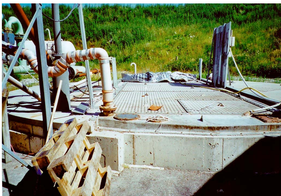
Billede 14 Bioforgasningsanlægget til husholdningsaffald i Vaarst-Fjellerad
