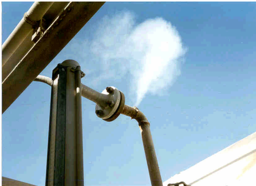
Figur A.7 Udslip af klor pga. tæring ved en svejsning
