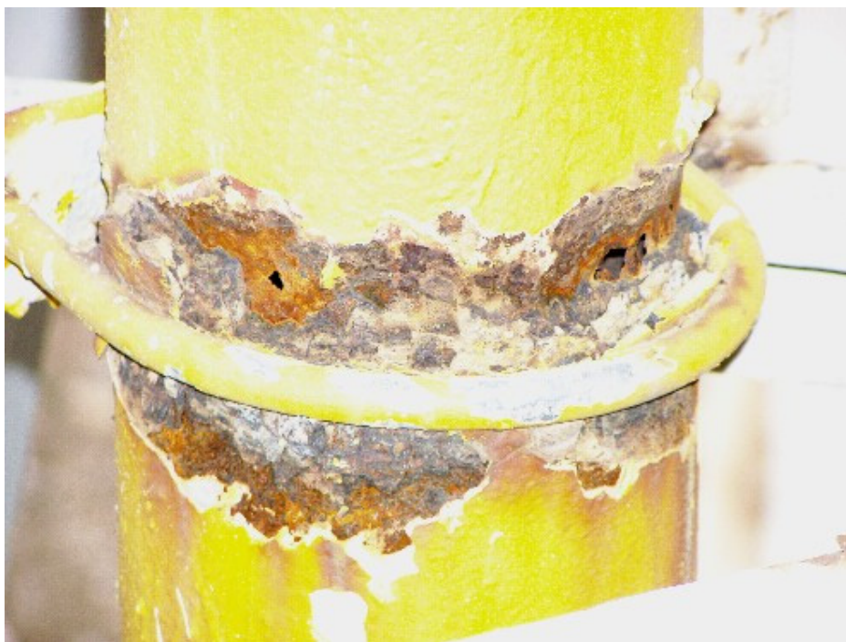
Figur A.10 Tæring som årsag til gasudslip i en vent linie.
