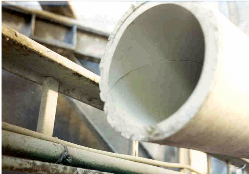
Figur A.4 Totalbrud i et 12 tomme PVC rør til syre, der skyldes fejlmontering af en ekspansionsbælg
