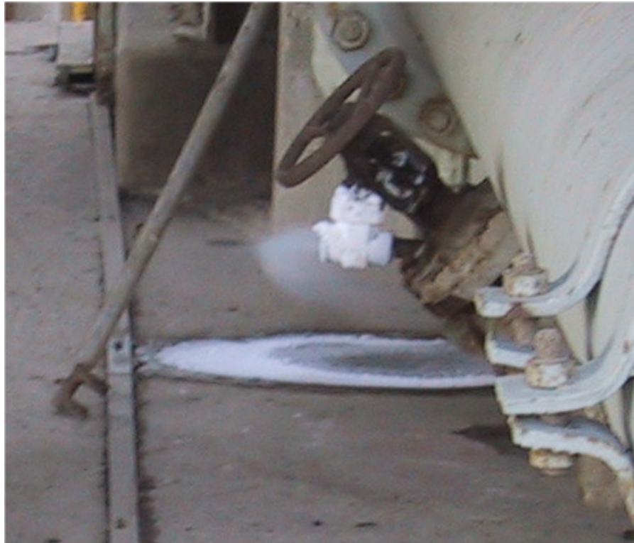
Figur A.8 Et mindre udslip af gas (propylen) pga. en ventillæk. Gassen er kold, fordi det kommer fra dampende væske. Bemærk at vinden blæser gassen tilbage mod udslipsretningen.
