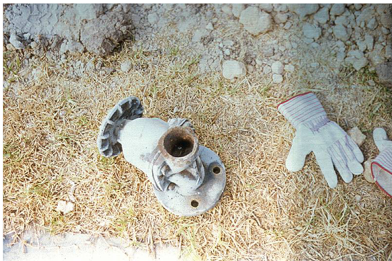
Figur A.5 Ventil knækket fra en syretank pga. stød under vedligehold
