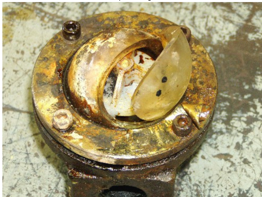
FigurA.9 Et knækket skueglas som kilde til et udslip (etylen gas og olie).
