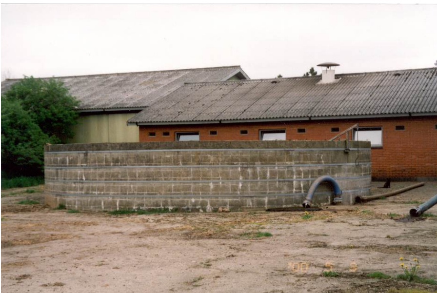
Figur 3.4 Blokstensbeholder, der er forsynet med spændebånd. Det er afgørende for båndenes positive virkning, at de opsættes af eller i samarbejde med en specialist, der kan vurdere båndenes virkning og den kraft, som de bør spændes til.
