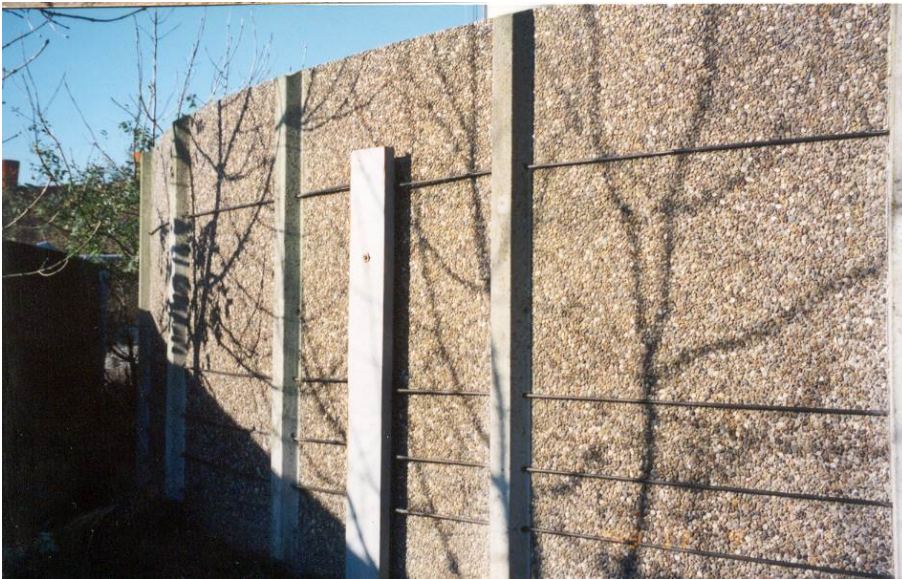
Figur 1.11 Dette er en ældre Muleby beholder, hvor opspændingen af kablerne på et vinkeljern er skjult bag afdækningspladen.
