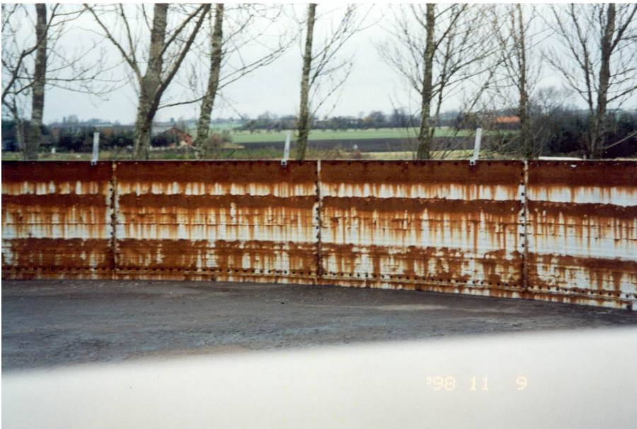
Figur 7.24 Overfladebeskyttelsen på indersiden af denne stålbeholder er stort set forsvundet og pladerne ruster.
