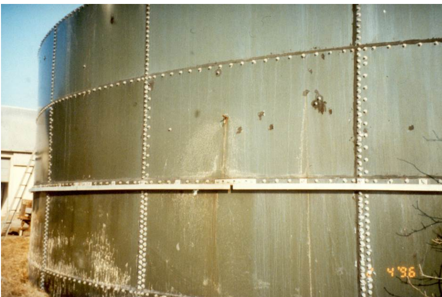
Figur 4.4 Stålbeholder med væg af flade profiler. Nogle stålbeholdere er som rustbeskyttelse glaserede, men hvis glasuren beskadiges, rustner stålet meget hurtigt.
