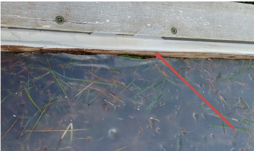
FIGUR 5.8 A HVID – REVNET VED KANT.
