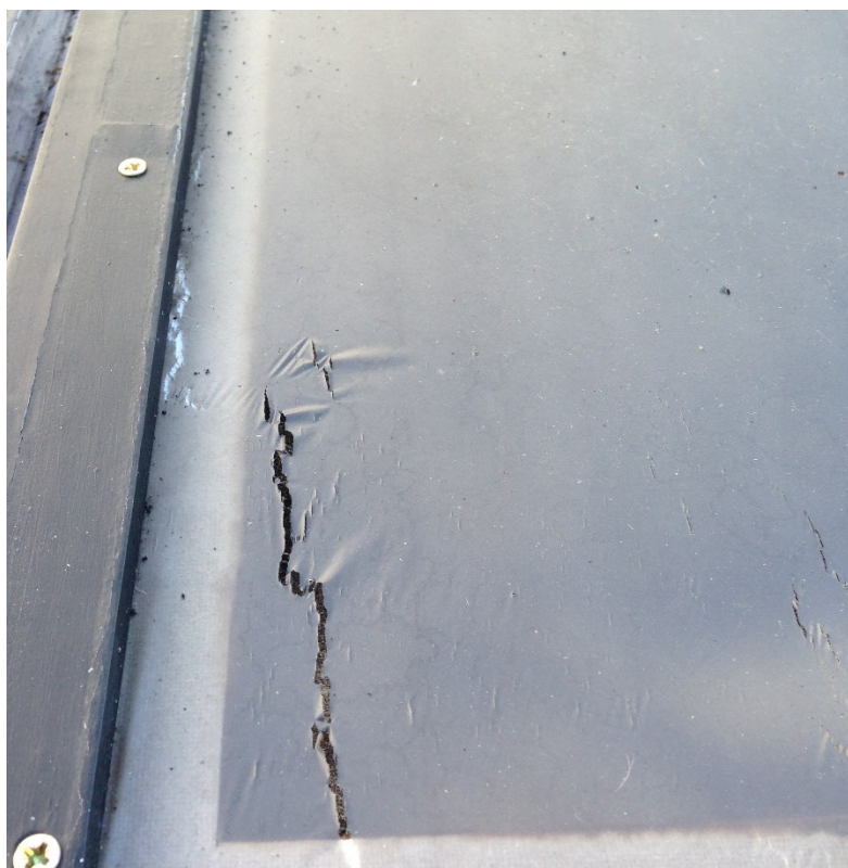
FIGUR 5.11 FOLIER PÅ TAG DEN 29. AUGUST – HUL I SORT A SAMT REVNER.
