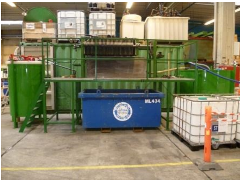
BILLEDE 6: SLURRY BUFFERTANK (VENSTRE), FILTERPRESSE (MIDT), FILTRATTANK (HØJRE)
