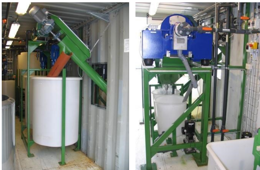
Figur 3: Et kik ind i begge containerne. Til højre ses centrifugen monteret i container 2. Til venstre ses transportøren for RGA fra centrifugen til skylletanken.
