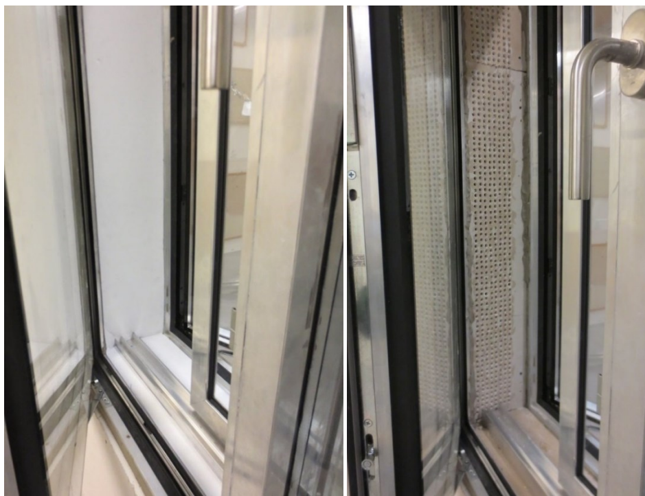
Illustration 8M. Fotos af anvendt karmabsorbent. Venstre side: 20 mm SUND®. Højre side: Perforeret gipsplade foran mineraluld i hulmuren.
