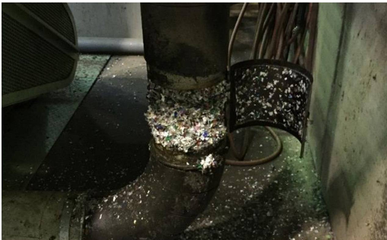
Figur 17: Eksempel på tilstoppet transportrør på VSA anlæg ved behandling af plastemballage fra husstande
