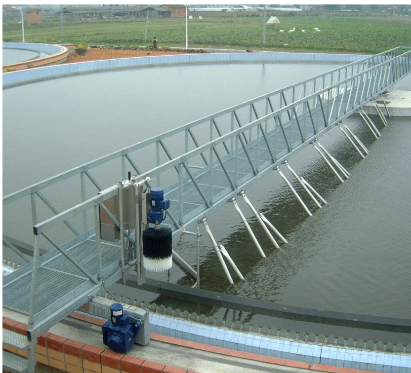
Fig 14 Foto af skrabebro i bundfældningsbassin
