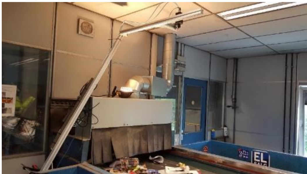
FIGUR 17 KAMERA PLACERET OVER EKSISTERENDE TRANSPORTBÅND I SORTERINGSKABINEN.
