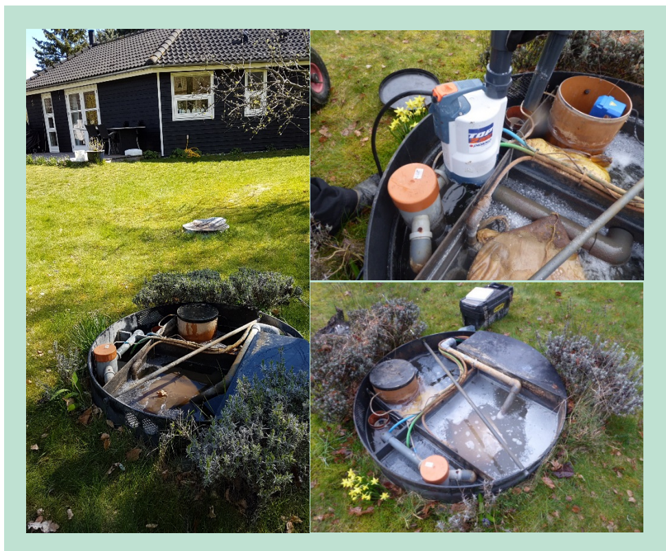
Figur 9-5 BioKube sommerhus-renseanlæg nr. 2871 (forsøgsanlæg C, SOP anlæg)
