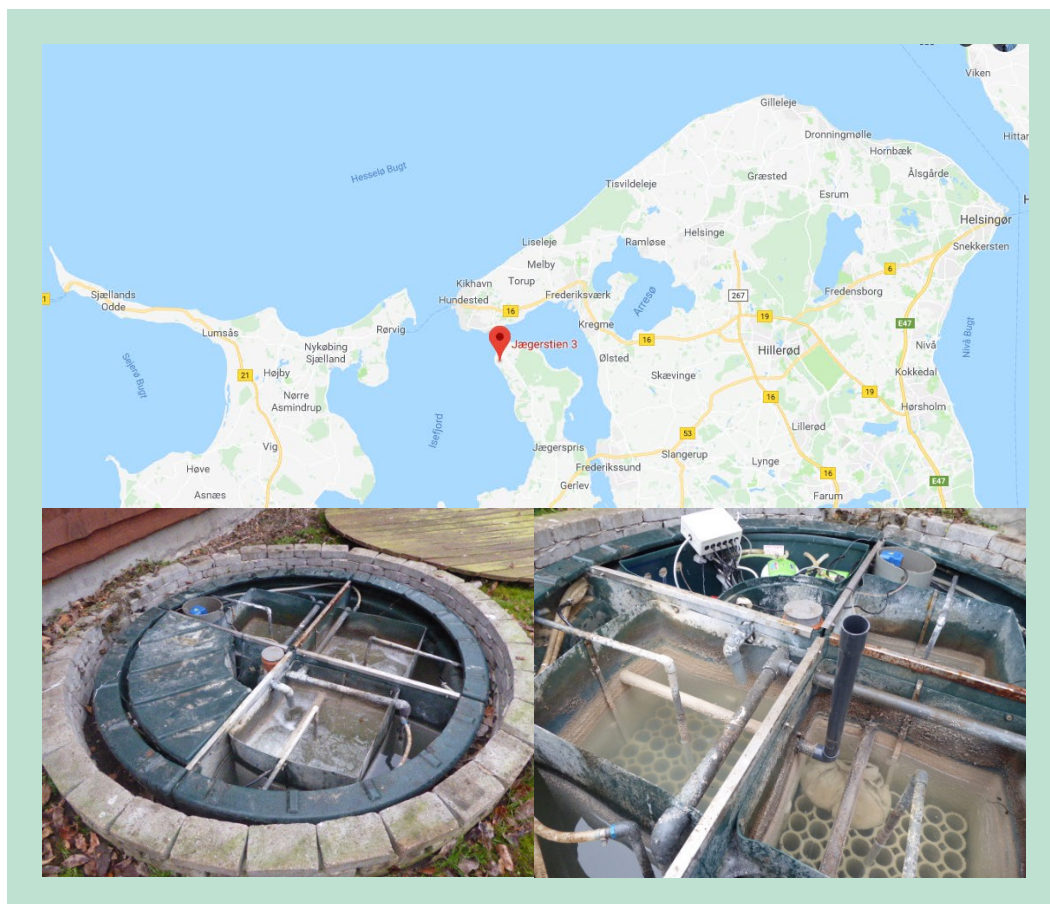
Figur 9-13 BioKube sommerhus renseanlæg nr. 43 (forsøgsanlæg G, SOP anlæg)
